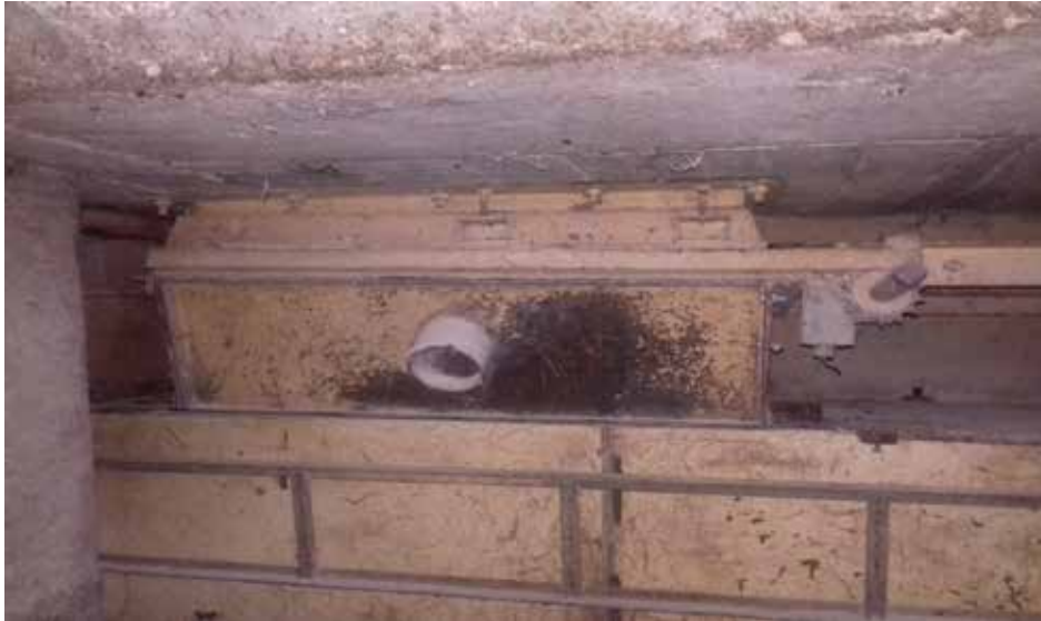
Figura 9. Zona 2 compuerta inferior silo 3. IV grupo , ubicada en el sotano Fuente: Planta Granvensa
