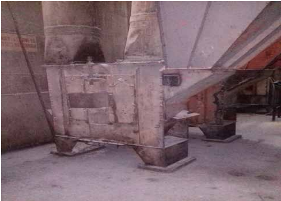
Figura 10. Zona 2, Base del elevador 7 , ubicada en el sotano Fuente: Planta Granvensa
