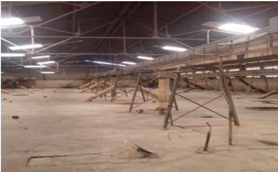
Figura 13. Zona 3, Transportador 78, ubicada en el piso 6
