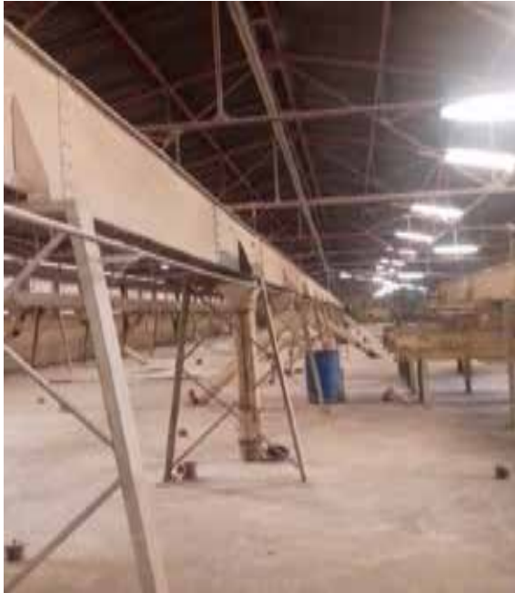
Figura 14. Zona 3, Transportador 78, ubicada en el piso 6
