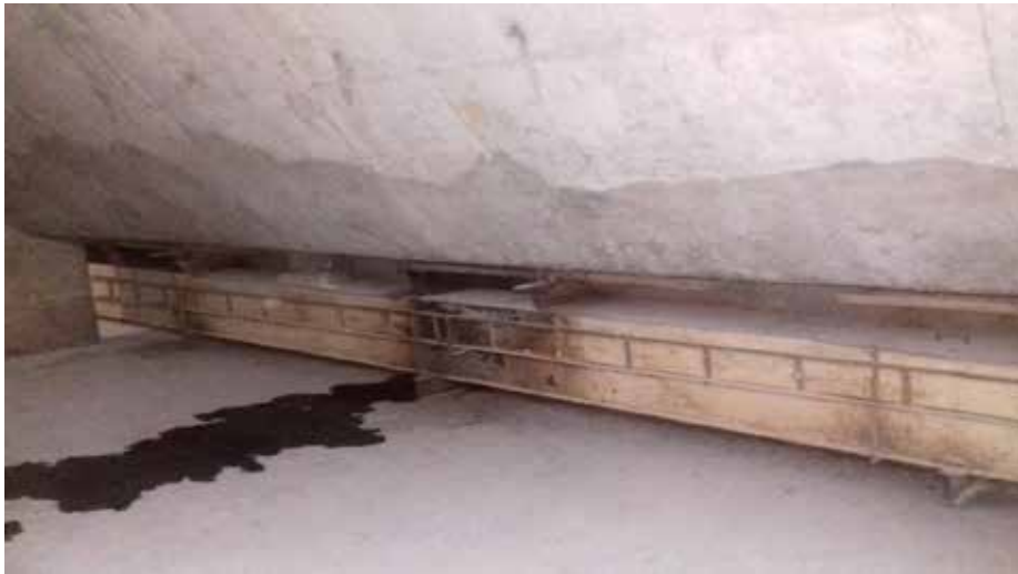
Figura 7. Zona 2 compuerta inferior silo 3 IV grupo , ubicada en el sotano
