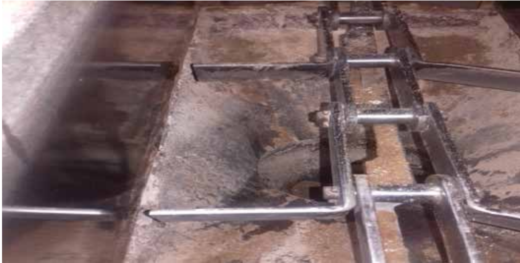
Figura 16. Zona 3, Compuerta Transportador 78 parte interna, que conecta con el transportador 7815, ubicada en el piso 6
