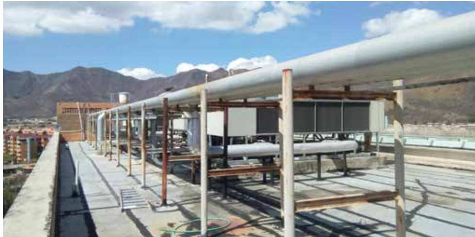
Figura 13. Sistema Chiller. Fuente: Castillo, Fuenmayor (2019)
