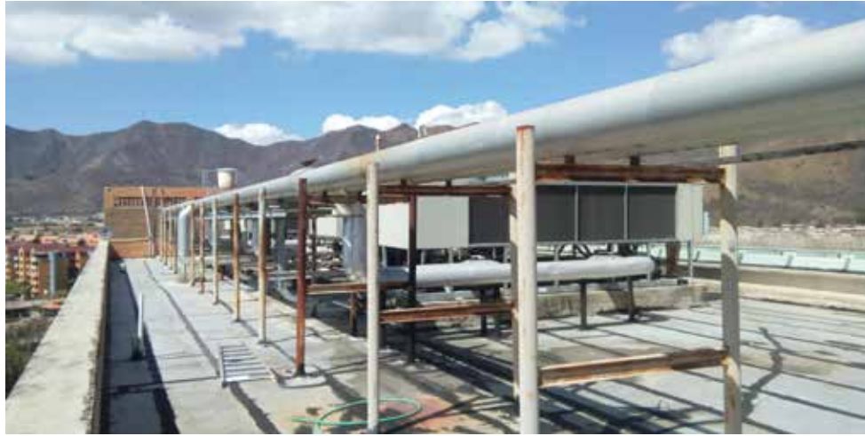
Figura 14. Sistema Chiller de la Universidad José Antonio Páez. Fuente: Castillo, Fuenmayor (2019)
