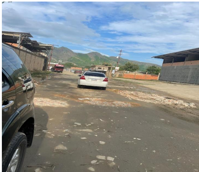
Figura 5. Mal estado de la vía Fuente: Blanco y Sosa (2022)
