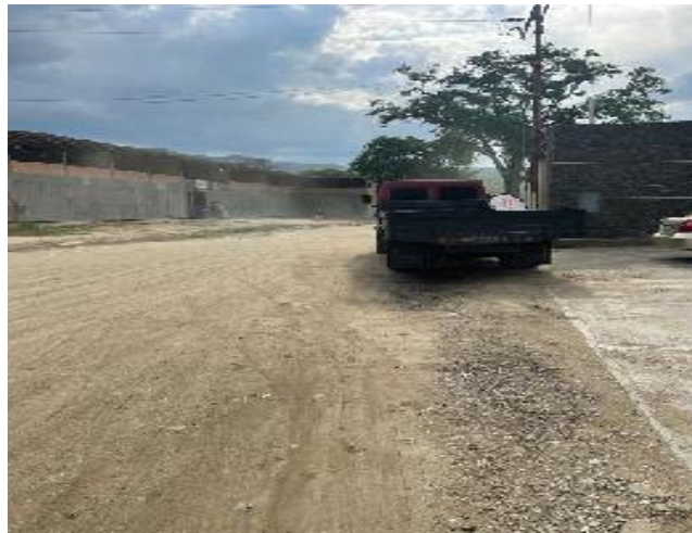
Figura 4. Deterioro de la vía Fuente: Blanco y Sosa (2022)
