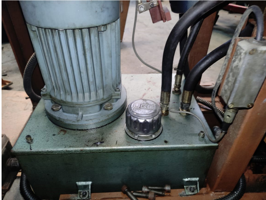
Figura 26. Tanque de almacenamiento de aceite y bomba hidráulica Fuente: El Autor (2022).
