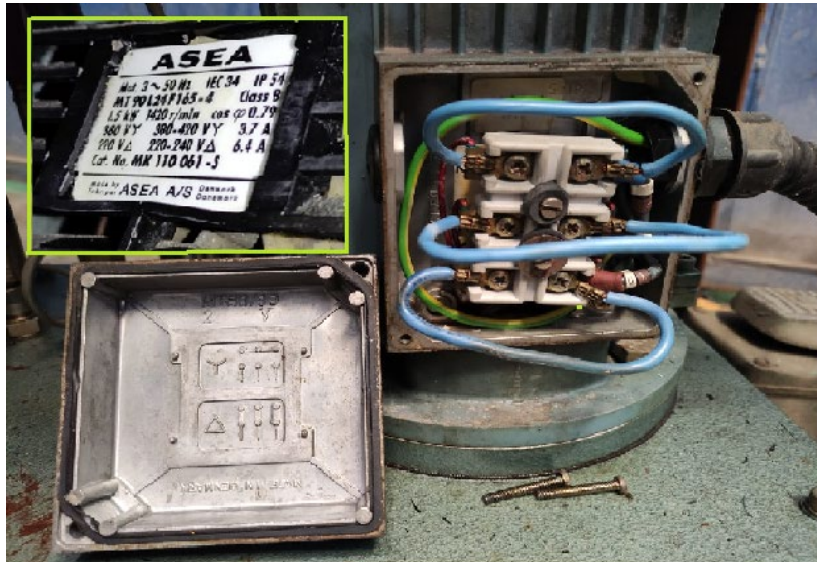
Figura 27. Placa de datos de la bomba hidráulica y conexión en bornera Fuente: El Autor (2022).
