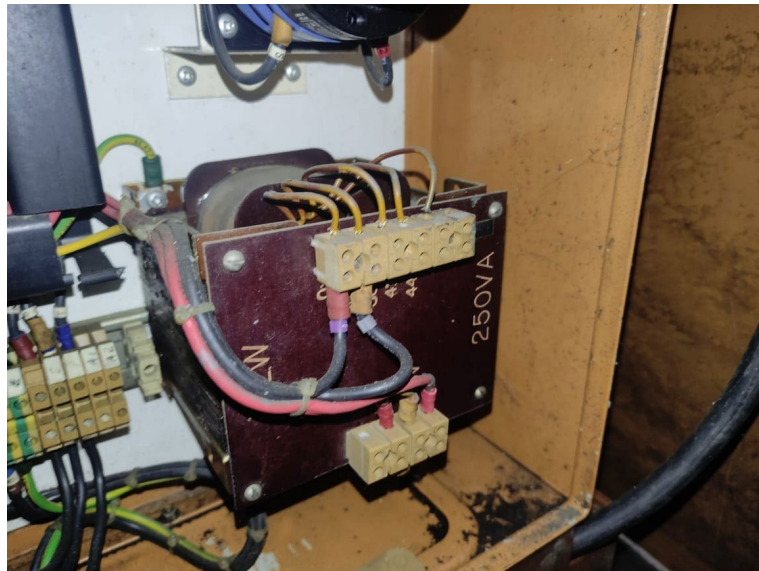
Figura 22. Transformador de 250VA.
