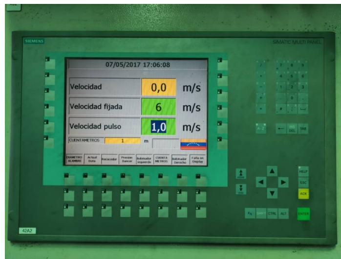
Figura 14. Interfaz hombre – máquina marca Siemens Fuente: Aralven S.A.
