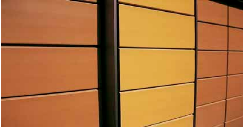
Figura 30: Detalle de revestimiento en cerámica (2014)
