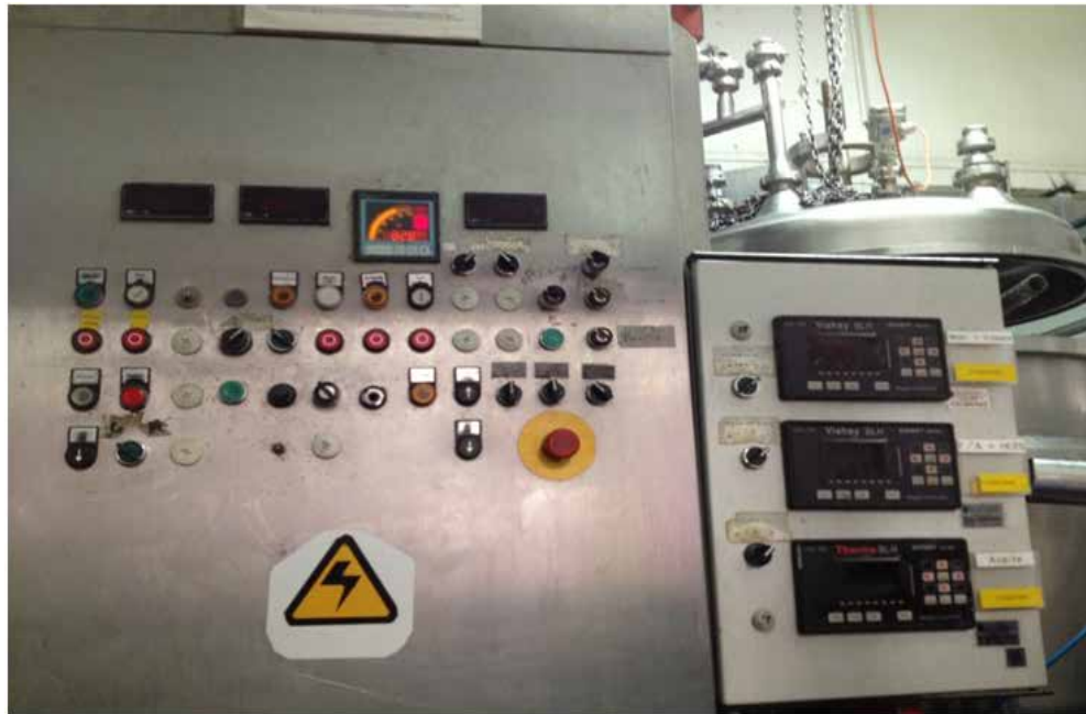
Figura 10. Parte frontal del tablero de control del Koruma
