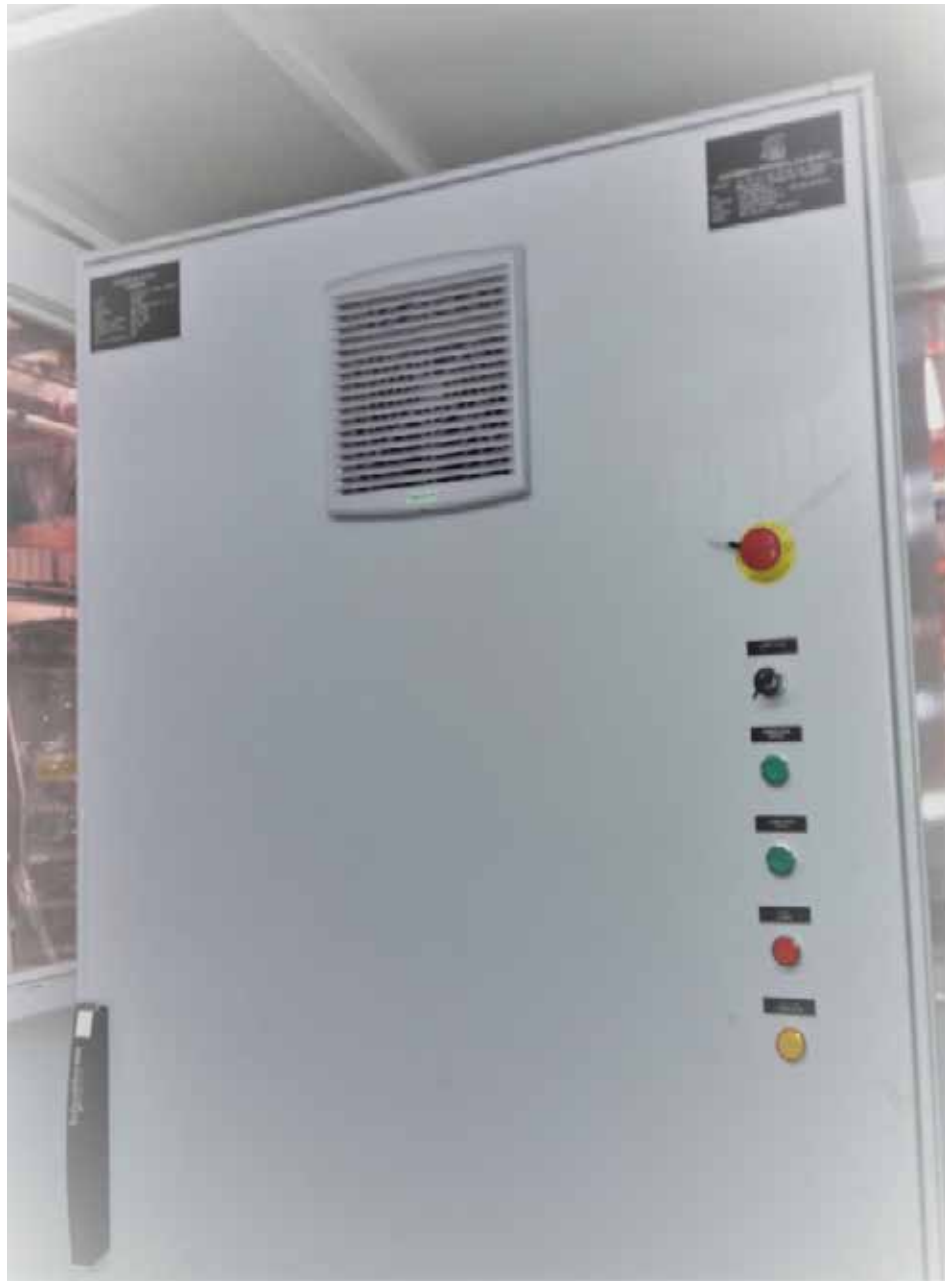
Figura 18. Parte frontal del nuevo tablero de control del Koruma
