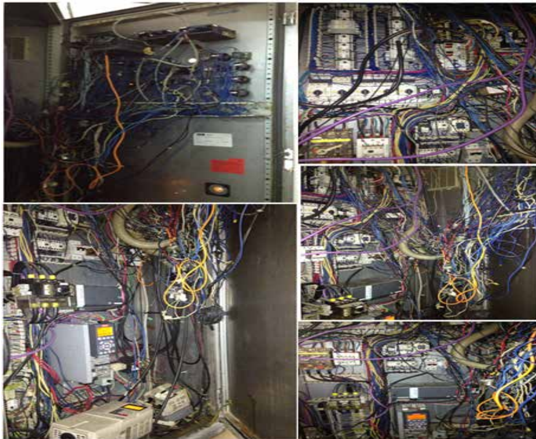
Figura 12. Estado de las conexiones internas del tablero de control del Koruma
