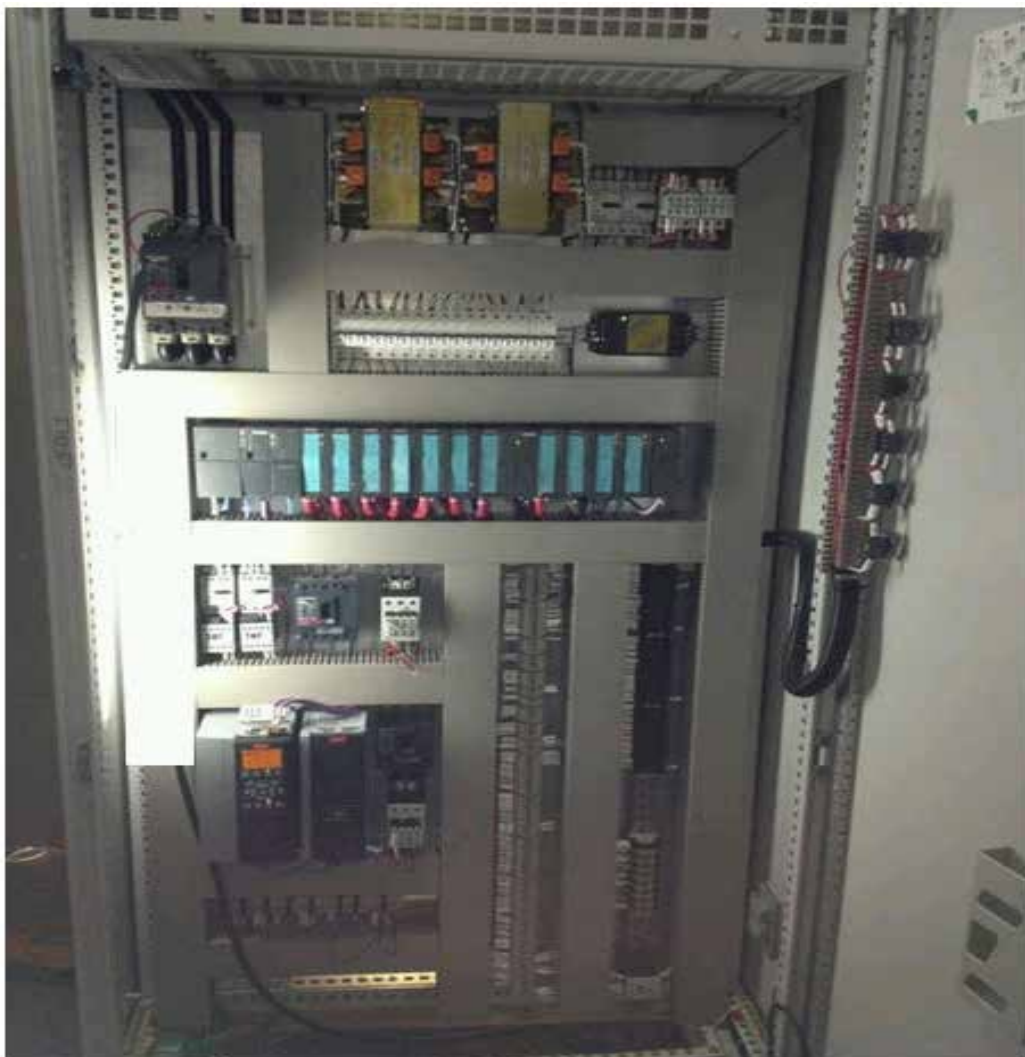
Figura 13. Parte interna del nuevo tablero de control del Koruma
