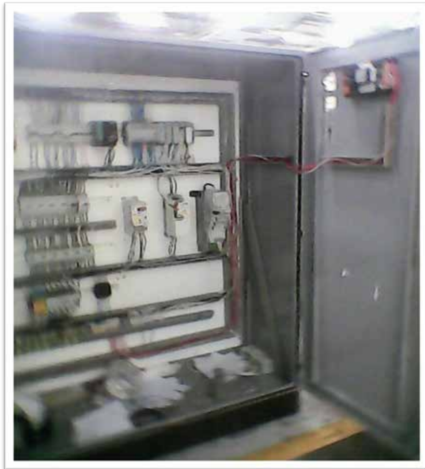
Figura 46. Estado actual del nuevo tablero eléctrico
