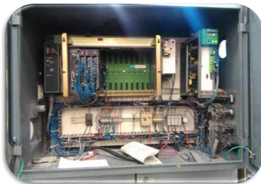
Figura 4. Imagen parcial del interior del tablero eléctrico de la envoladora de servilletas Z grande. Fuente: Elaboración Propia (2017)
