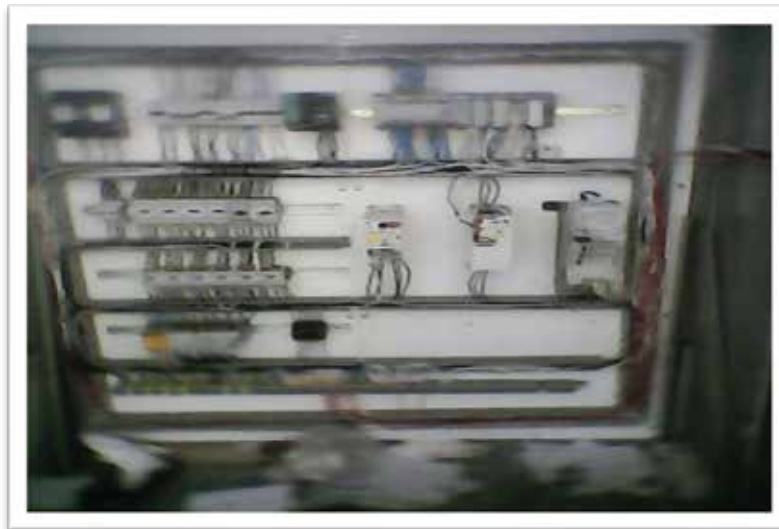
Figura 45. Estado actual del nuevo tablero eléctrico
