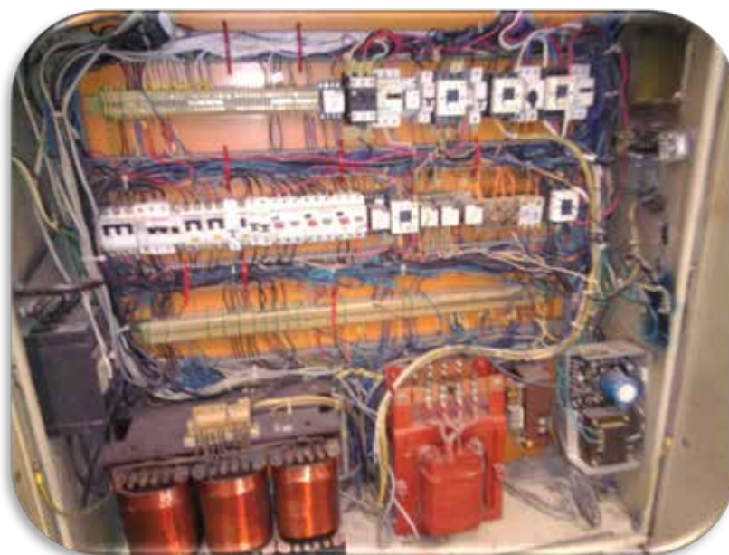
Figura 5. Imagen parcial del interior del tablero eléctrico de la envoladora de servilletas Z grande. Fuente: Elaboración Propia (2017)
