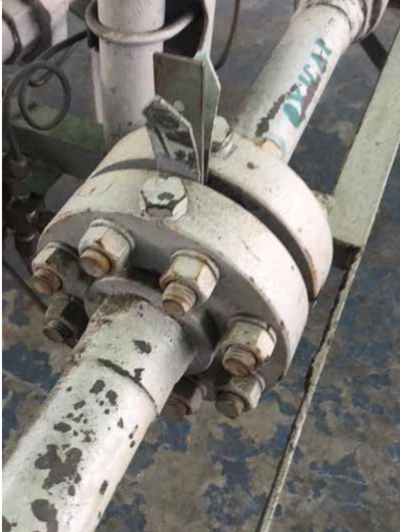
PLACA DE ORIFICIO EN MANIFOLD TUBERIA 2"
