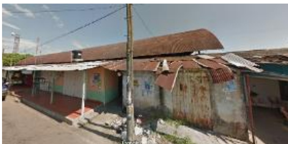
Figura 5 Estado actual del mercado municipal en el sector Barrio El Centro. Fuente: Google Street View (07/2014)
