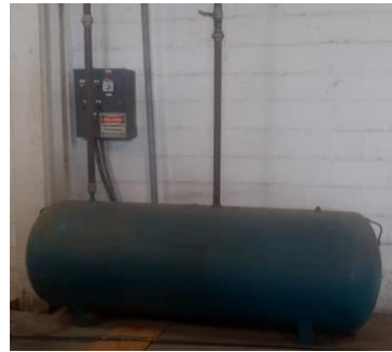
Imagen 5. Vista Frontal del Compresor y Tablero Eléctrico del Compresor
