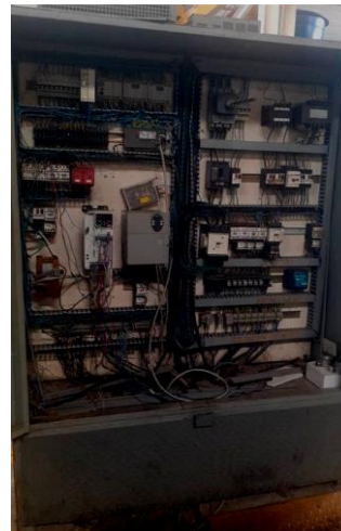
Imagen 8. Vista Frontal Interna del Tablero Eléctrico “A”
