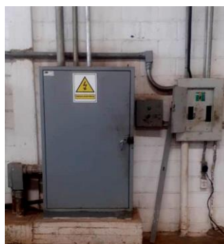
Imagen 1. Vista Frontal Tableros Eléctricos Principales N°1 Y N°2
