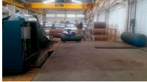
Imagen 4. Vista Lateral General de Referencia para la Ubicación del Tablero Eléctrico del Compresor
