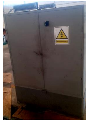
Imagen 7. Vista Frontal Externa del Tablero Eléctrico “A”
