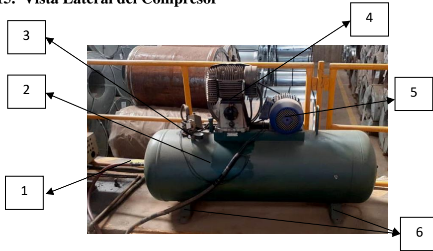
Figura N°15. Vista Lateral del Compresor
