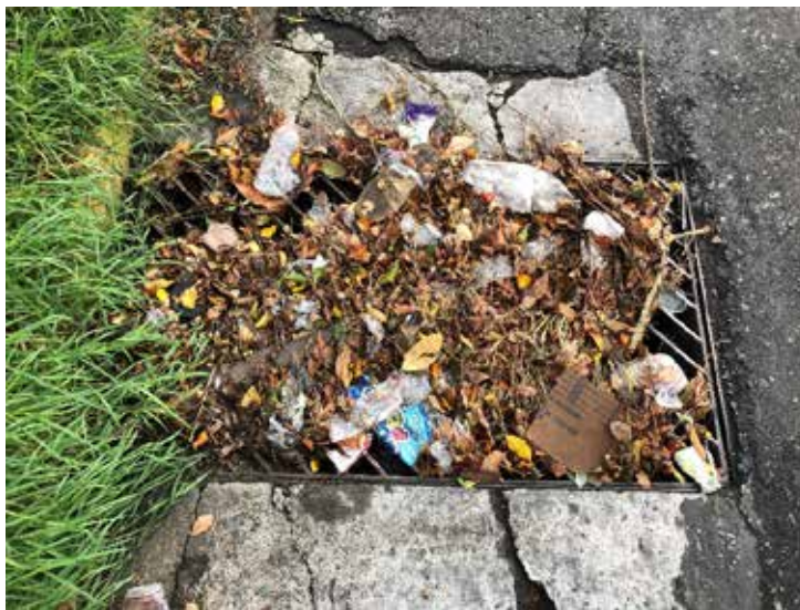
Figura 53: Obstrucción de sumidero de rejilla.
