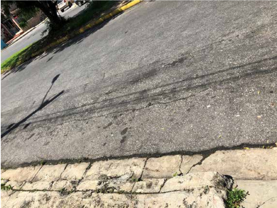
Figura 42: Fisuras de borde con evidente fractura de la cuneta y brocal, Av. Circunvalación Sur.
