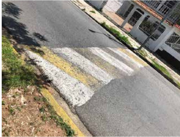
Figura 50: Reductores de velocidad en mal estado, Calle 162.
