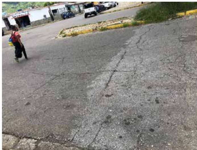
Figura 39: Parche deteriorado con fisuras multidireccionales, piel de cocodrilo y notable pérdida del brocal, Calle 162.
