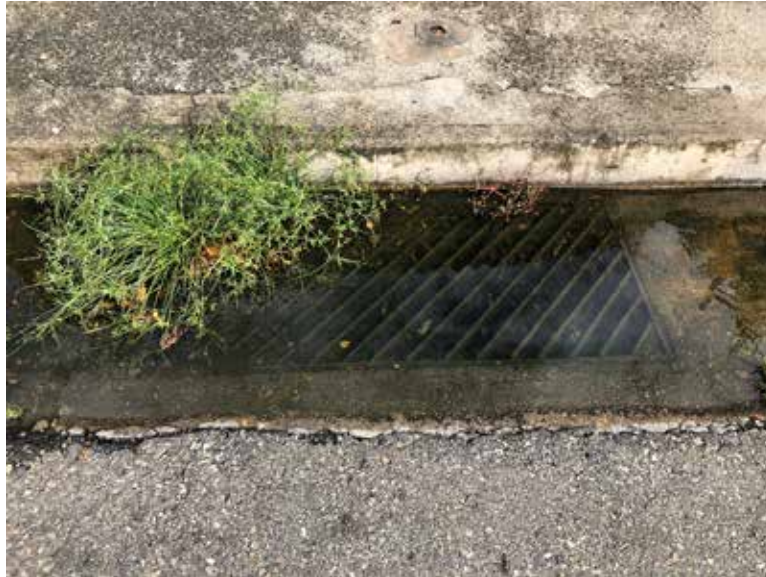
Figura 54: Sumidero de rejilla tapado.
