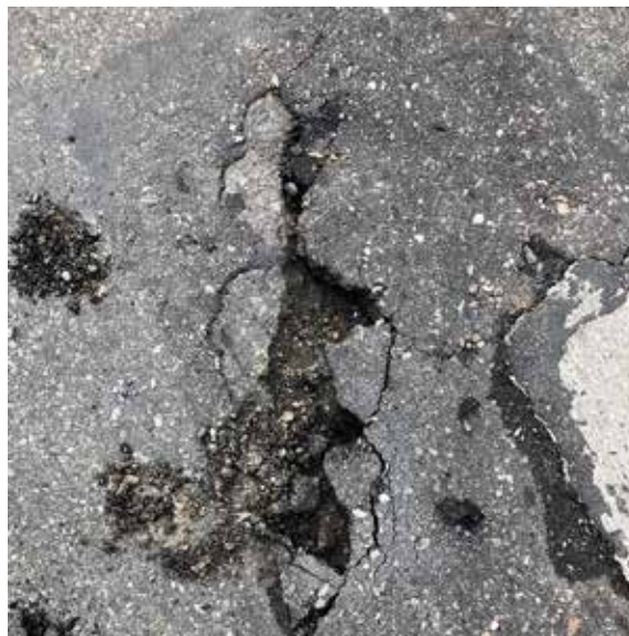
Figura 44: Descascaramiento del pavimento flexible, Av. Circunvalación Sur.
