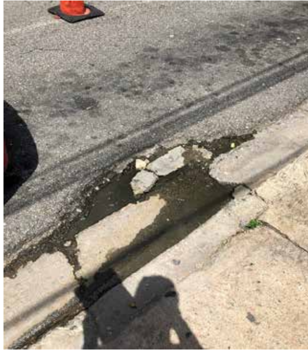
Figura 38: Separación de berma con descascamiento, Calle 162.
