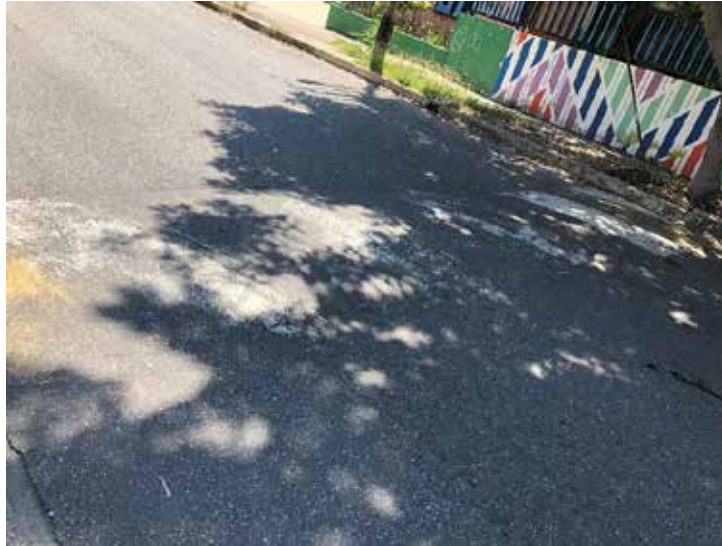
Figura 52: Reductores de velocidad en mal estado, Av. Circunvalación Sur.
