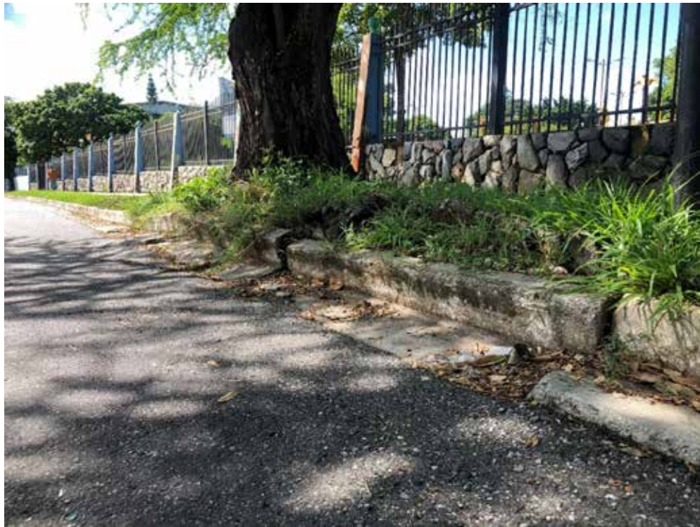
Separación de berma:
