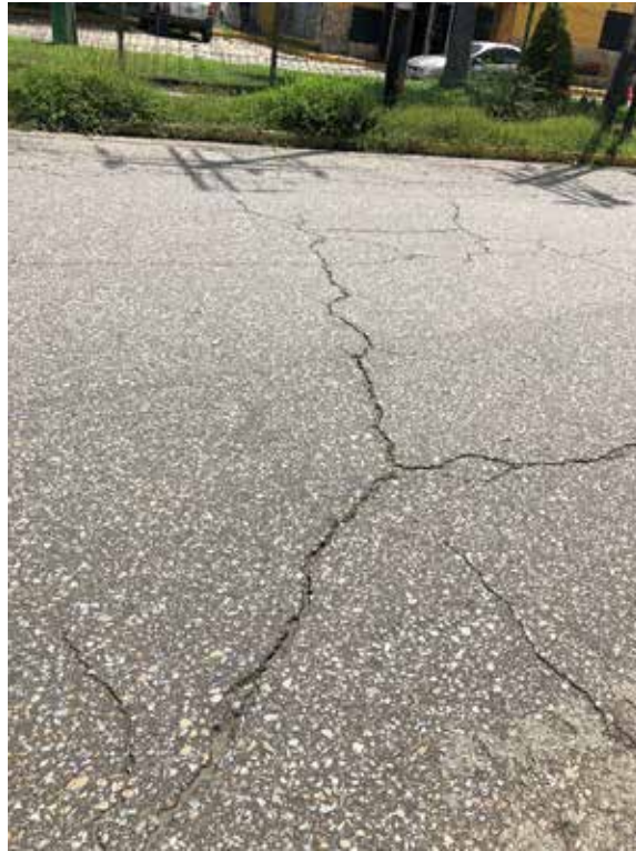
Figura 40: Fisuras longitudinales y transversales, Calle 162.
