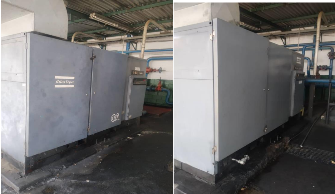
Figura N° 12. Compresores de Aire
