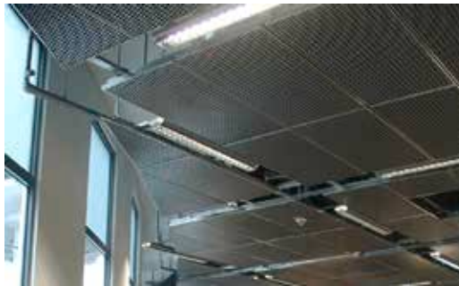
Figura 78. Lamina de metal micro perforado.
