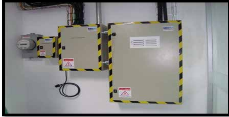
Figura 12. Tablero de distribución Eléctrica. Fuente: Mastercircuito (2017).
