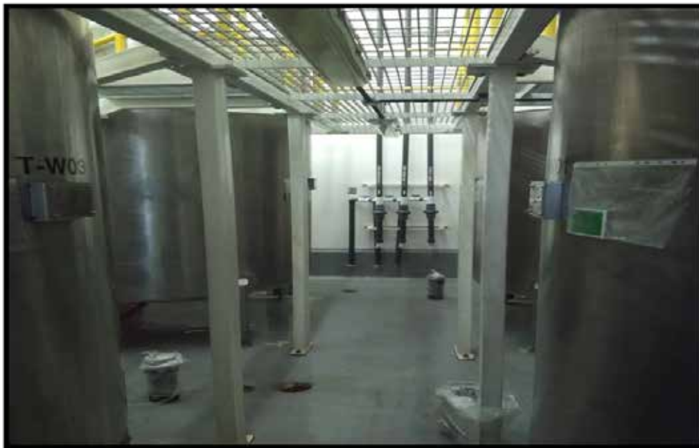
Figura 25. Tanques de Almacenamiento de materia prima del Área de Mezclado empresa Pharsana de Venezuela, C.A. Vista Inferior Fuente: Ronald Stanisavlevich 2017.
