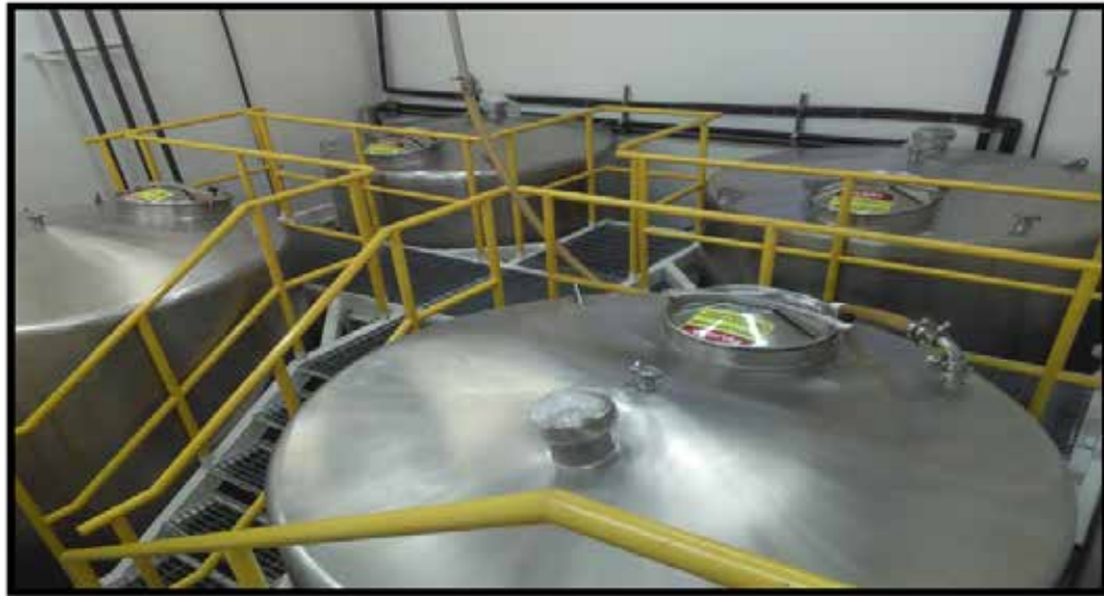
Figura 24. Tanques de Almacenamiento de materia prima del Área de Mezclado empresa Pharsana de Venezuela, C.A. Vista Superior Fuente: Ronald Stanisavlevich 2017.
