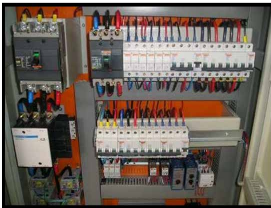
Figura 11. Tablero de distribución para aplicaciones industriales. Fuente: Deltaa1 (2017).
