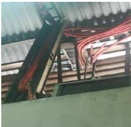
Figura 8.Red de Fibra óptica instalada en toda el área de la planta
