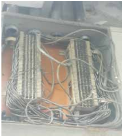
Figura 7. Cableado multipar expuesto dentro de la planta
