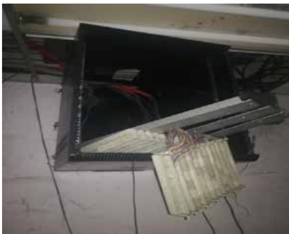
Figura 6. Condiciones actuales de cableado multipar y galleta de conexiones de la red telefónica de la la planta Goodyear de Venezuela. Fuente: Autor
