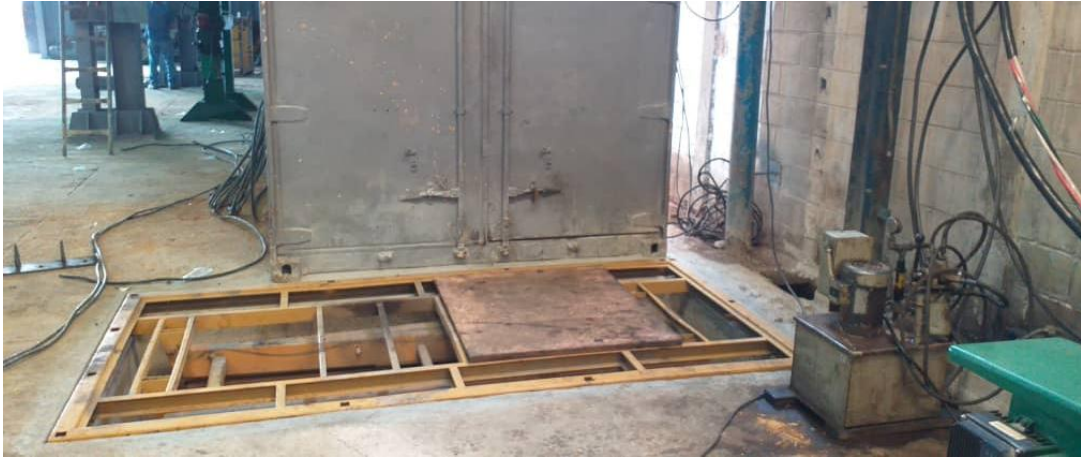
Figura 15: Cableado eléctrico y de bombeo de aceite.
