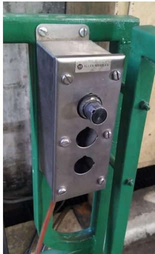
Figura 43: Caja de Control
