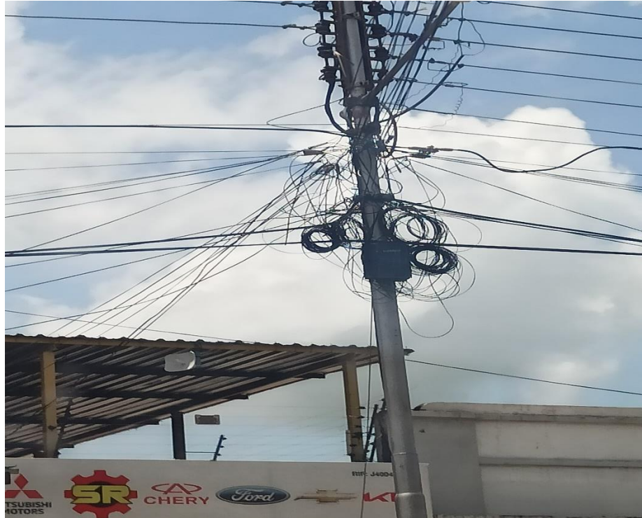
Figura 26. Incumplimiento de normas para arreglo de cableado. Fuente: Ramírez, Lugo. (2023).
