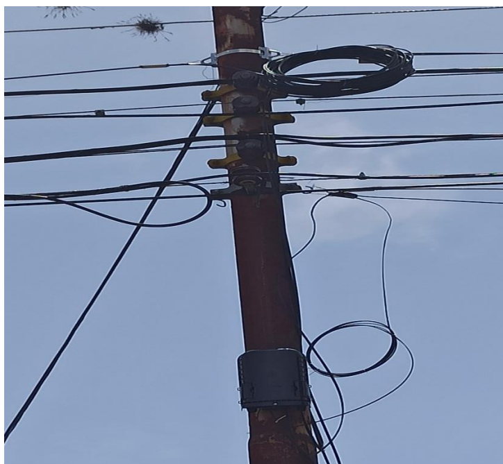
Figura 22. Instalaciones de fibra óptica Supernova. Fuente: Ramírez, Lugo (2023)
