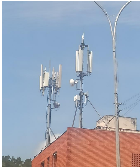
Figura 20. Antenas sectoriales para conexiones de Inter. Fuente: Ramírez, Lugo (2023)
