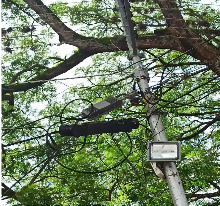
Figura 19. Instalaciones de cableado para CANTV. Fuente: Ramírez, Lugo (2023)
