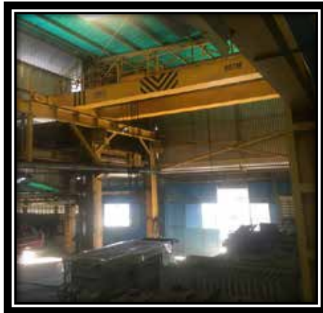
Figura 3: Grúas De Puente De 60 Ton FUENTE: Herd  A, Zarate J (2021)
