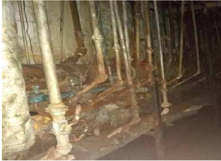
Figura 15. Tuberías del túnel J-2.
