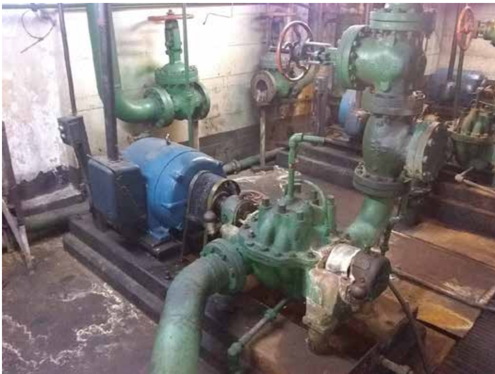
Figura 14. Bomba para el suministro de fluido hidráulico.
