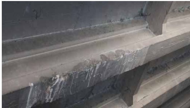
Figura 26: Desgaste de viga “4”
