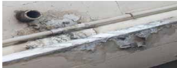
Figura 31: Deterioro del drenaje del costado oeste
