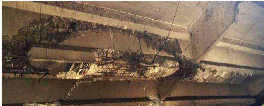
Figura 24: Desgaste de viga “2”
