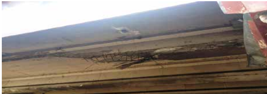
Figura 20: Sistema de drenaje deteriorado.
