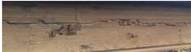
Figura 29: Deterioro del tablero
