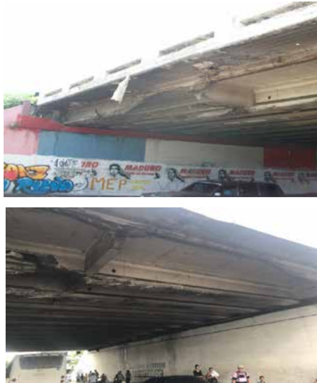
Figura 44: Desgaste de las vigas por el flujo vehicular año (2013 y 2018).
