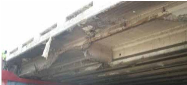
Figura 23: Desgaste de viga “1”
