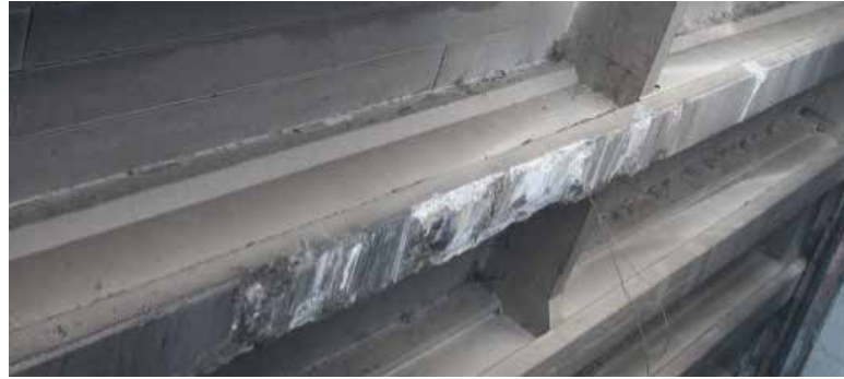
Figura 25: Desgaste de viga “3”
