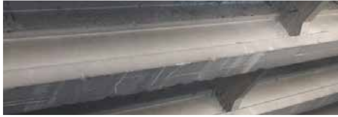
Figura 27: Desgaste de viga “5”
