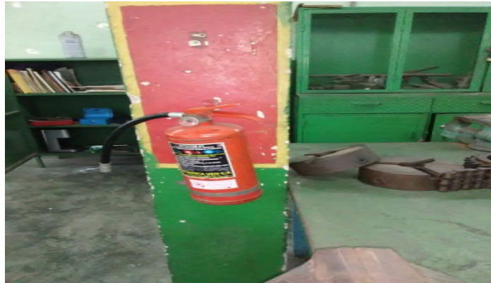
Figura 15: equipos contra incendios
