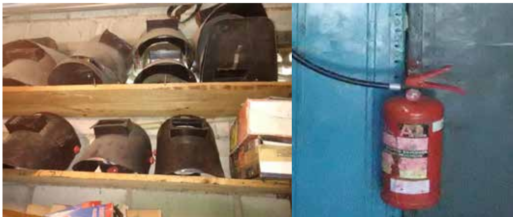
Figura 21. Extintor y condiciones en las que se encuentran las repisa
