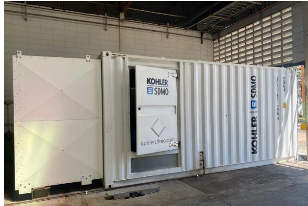
Figura 21: Planta eléctrica de línea 6
