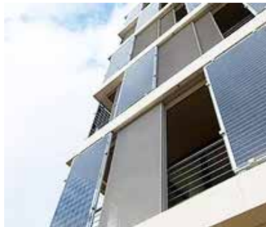
Figura 50. Paneles fotovoltaicos Colt. Fuente: http://fachadasdinamicas.wixsite.com/colt/shadovoltaic (2017).
