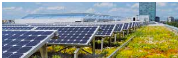
Figura 59. Cubierta extensiva vegetal con instalación de paneles solares, Centro tecnológico de Munich. Fuente: http://www.zinco-cubiertas-ecologicas.es/energia_solar/index.php (2017).
