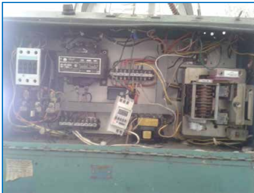
Fig. 24 Tablero de control de la caldera 2 (en la caldera 1)
