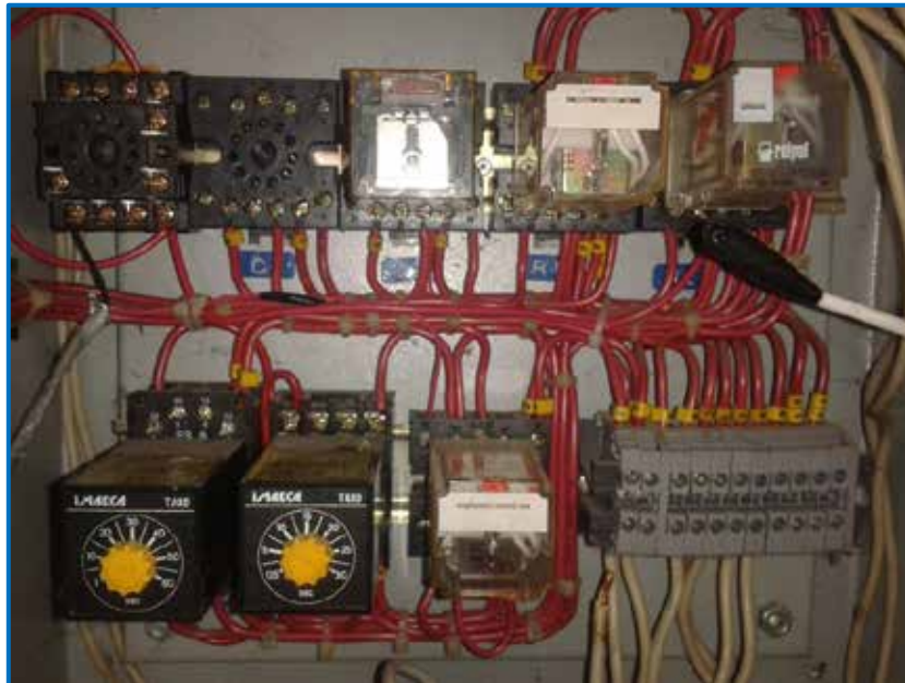
Fig. 31 alarma de las calderas 1 y 2
