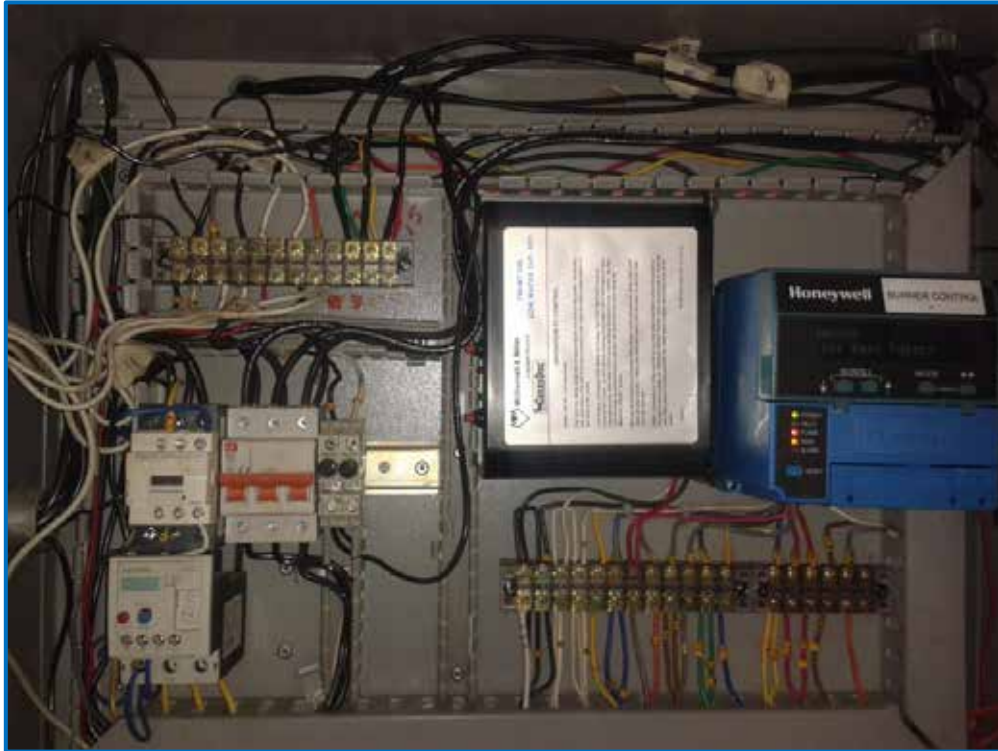
Fig. 30 Tablero de control de la caldera 3
