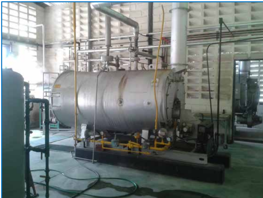
Fig. 2 Sala de calderas (enfoque caldera 1).
