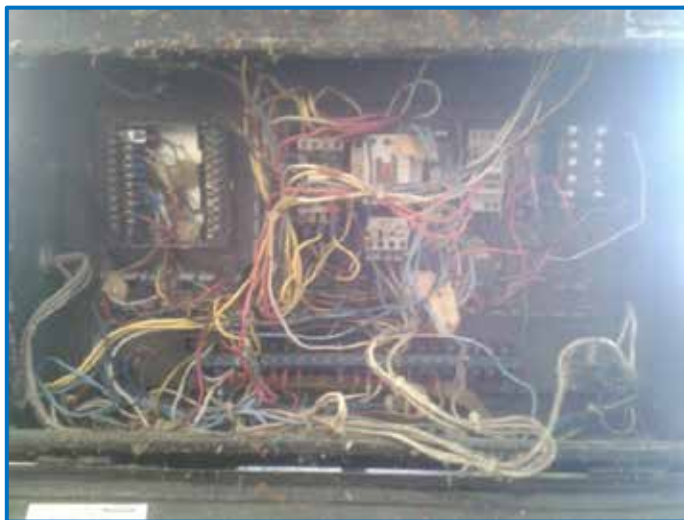
Fig. 28 Tablero de control de la caldera 1 (en la caldera 2).
