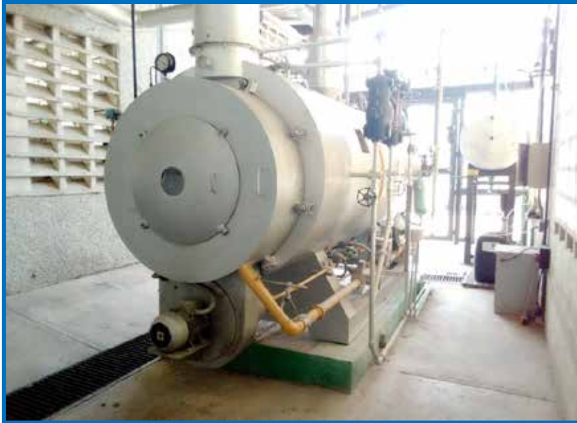
Fig. 29 Caldera 3 durante operación
