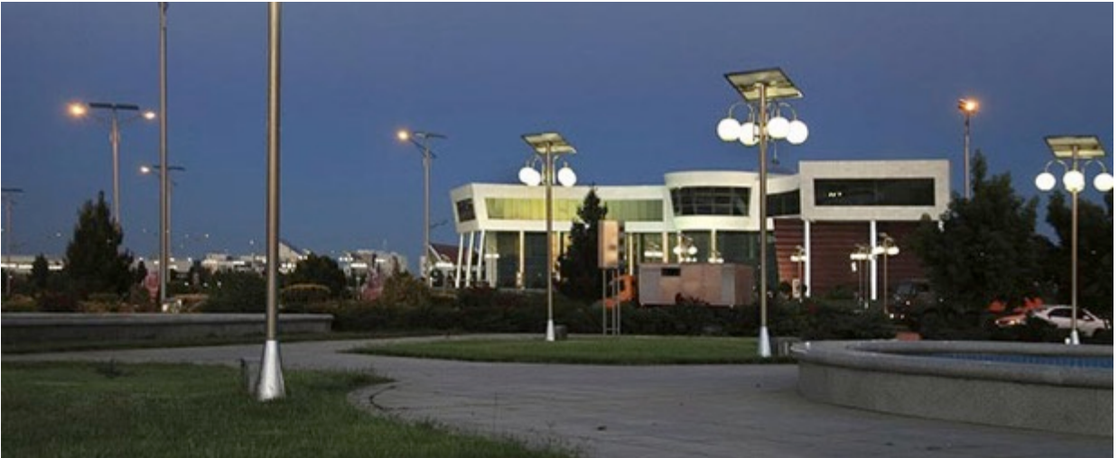
Figura 21: Ejemplo de alumbrado público con paneles fotovoltaicos (2017)
