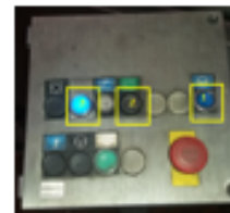
Imagen #9. Panel de control del embalador
