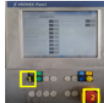
Imagen #8. Tablero de control vías de cajas
