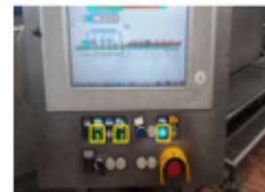
Imagen #6. Panel de control del embalador
