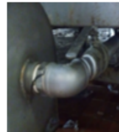
Imagen #9. Válvula principal del aire
