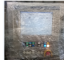
Imagen #3. Partes eléctricas protegidas del agua
