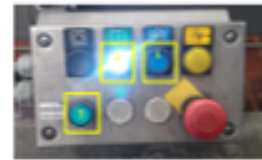
Imagen #9. Tablero de control del rechazador de caja
