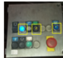
Imagen #11. Panel de control del embalador
