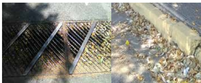
Figura 17: Alcantarillas y Cuneta Obstruidas.
