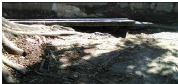
Figura 39: Deterioro de la Acera por las raíces de los árboles.
