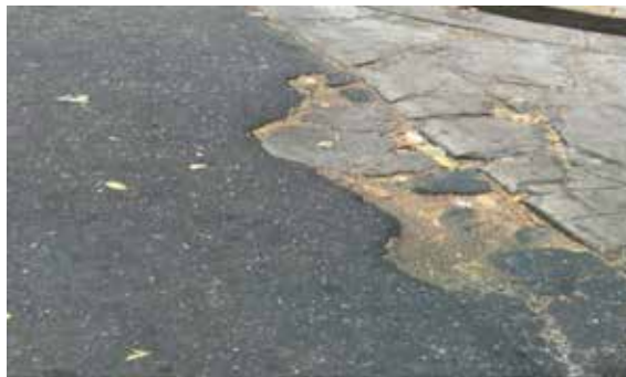
Figura 21: Deterioro de la Acera y Pavimento al frente del C.C Concepto La Granja.
