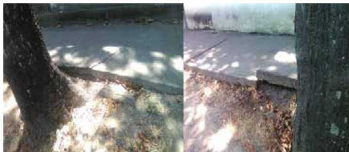
Figura 28: Deterioro de las Aceras en el Tramo 7.
