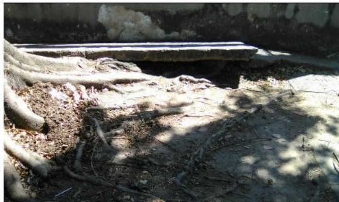
Figura 12: Deterioro de la Acera por las raíces de los árboles.
