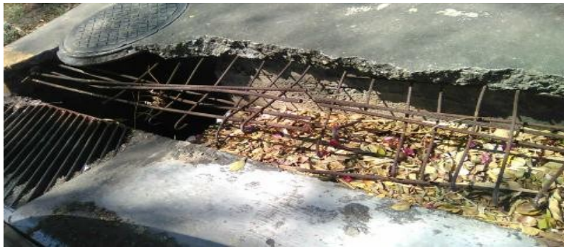
Figura 11: Obstrucción y deterioro del drenaje.
