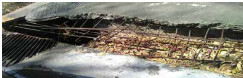
Figura 38: Obstrucción y deterioro del drenaje.
