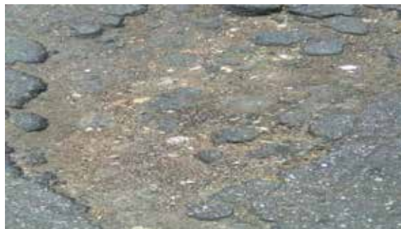
Figura 22: Desprendimiento del Material Granular.
