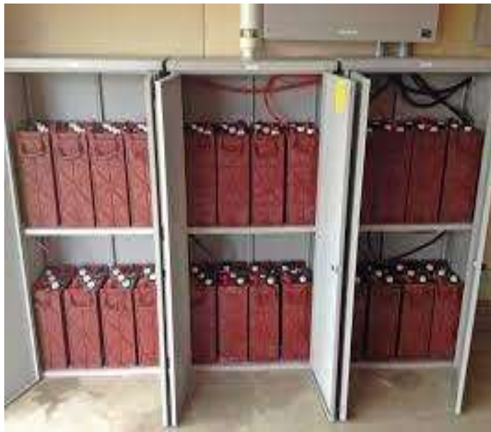
Figura 10 .Banco de baterías en paralelo y serie( https://www.suriaenergy.com/ )
