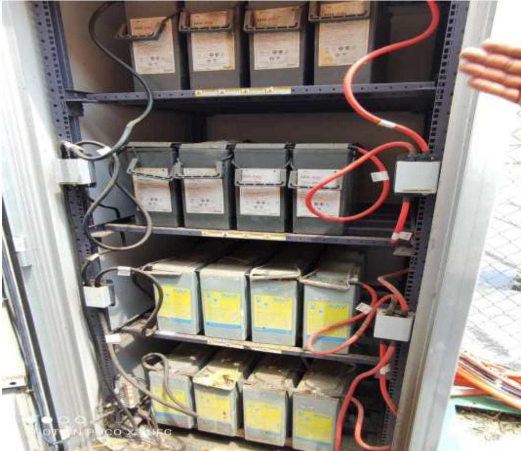
Figura 1. Banco de baterías inoperativo (Sinclair Gabriel 2022)
