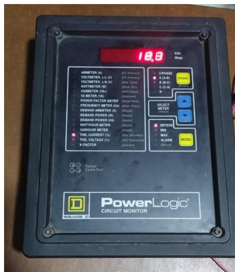
Figura 8: Medición de THD%I en paralelo
