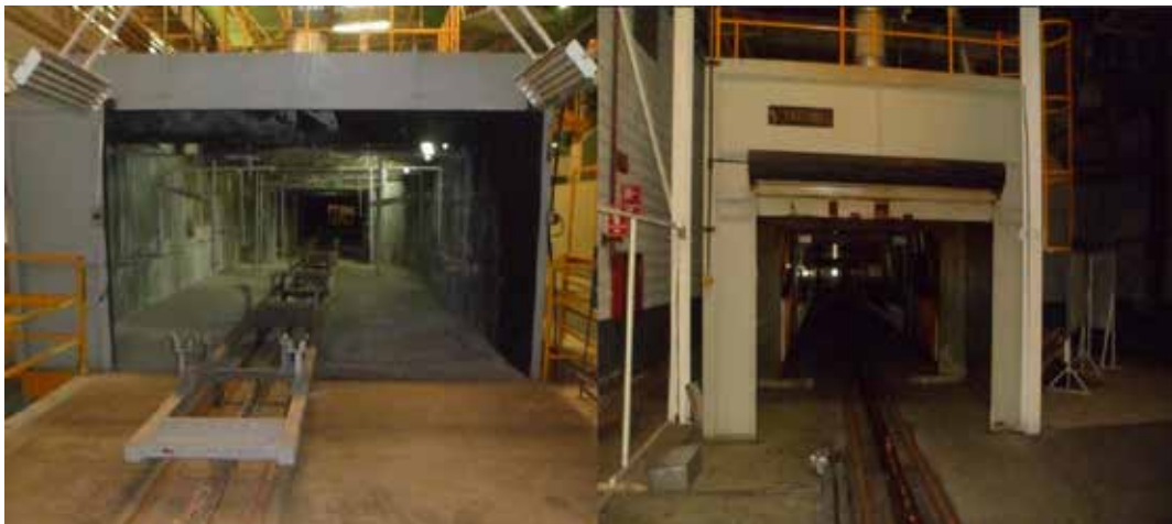
Figura 8: Túnel de fosfato /Sistema de fondo por inmersión (ecoat)
