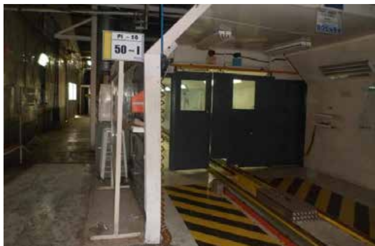
Figura 10: Cabina y Horno de Fondo Fuente: Ojeda, R. (2018).
