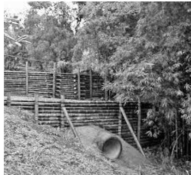
Figura 27 Tubería de gran diámetro para canalizar las aguas.
