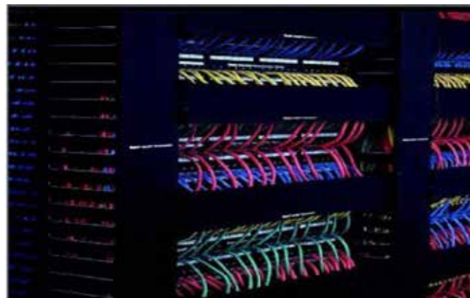
Figura 19. Sistema Panduit para administración de cable horizontal y vertical
