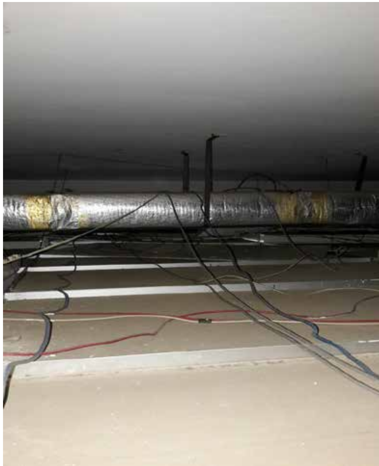
Figura 29: Parte del cableado nivel superior del CIAU
