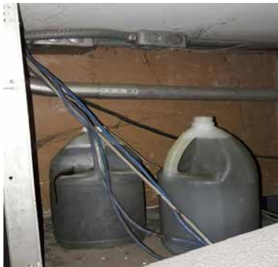
Figura 31: Parte del cableado nivel inferior
