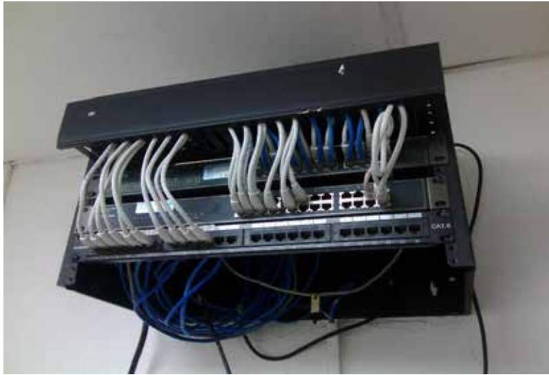
Figura 28. Rack informatica de soporte
