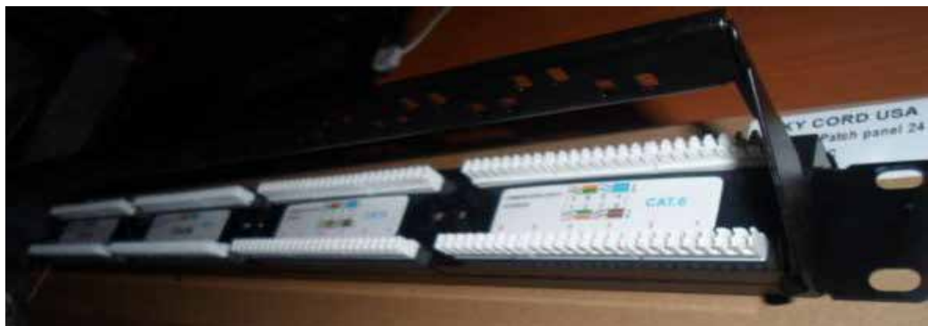
Figura 33. Patchpanel RJ-45 con blindaje categoria 6 frontal
