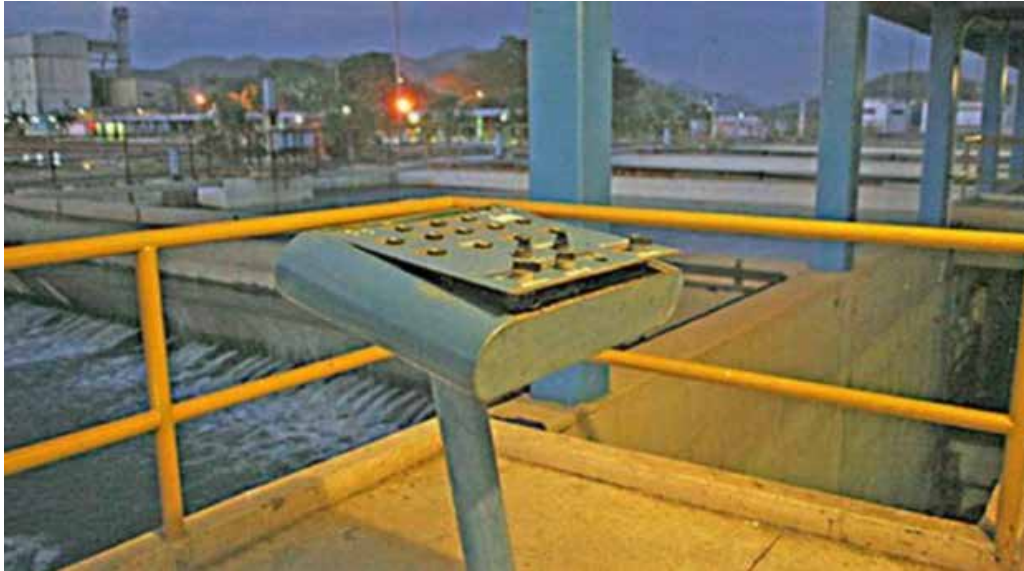
Figura 16. Controladores eléctricos Planta de Tratamiento Alejo Zuloaga, Valencia, Estado Carabobo.
