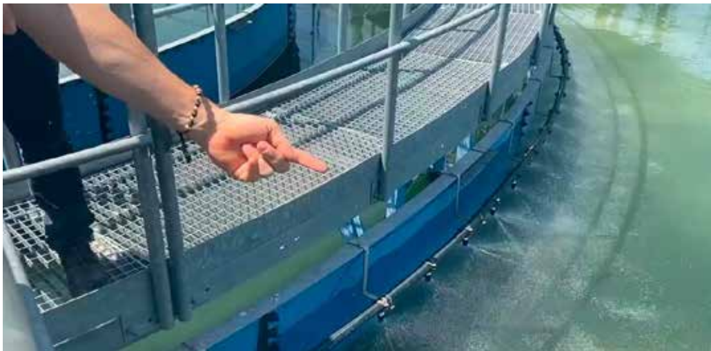
Figura 17. Filtraciones Planta de Tratamiento Alejo Zuloaga, Valencia, Estado Carabobo.
