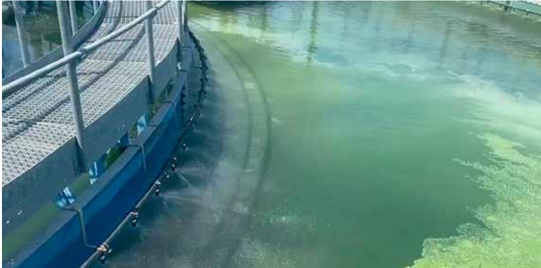
Figura 18. Filtraciones Planta de Tratamiento Alejo Zuloaga, Valencia, Estado Carabobo.
