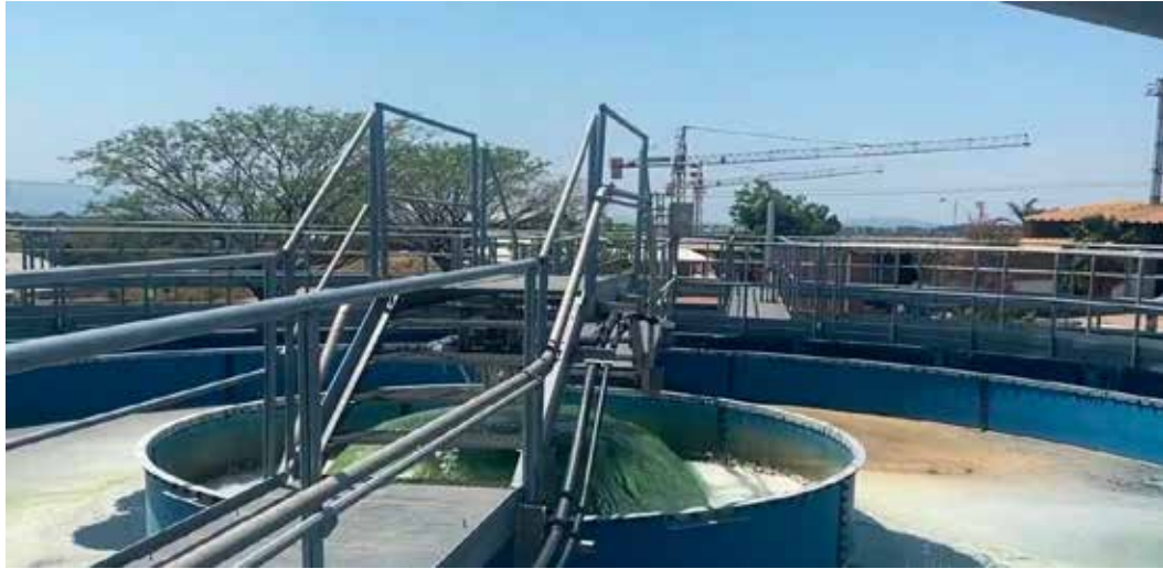
Figura 14. Sedimentadores Planta de Tratamiento Alejo Zuloaga, Valencia, Estado Carabobo.
