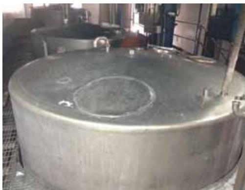
Foto N° 3: Tanque de almacenamiento
