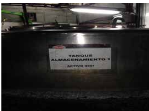
Foto N° 4: Tanque de almacenamiento
