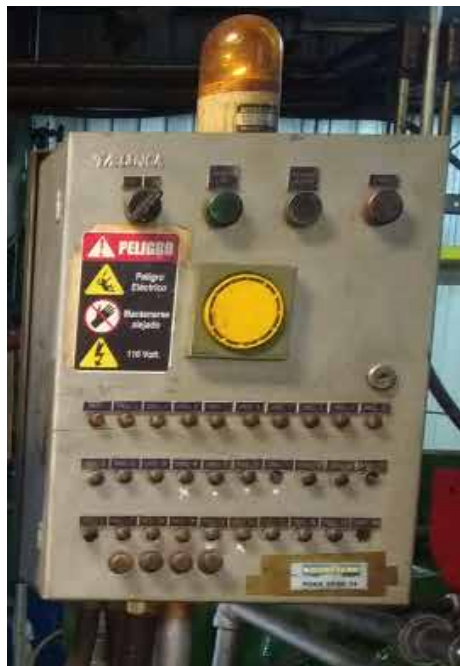
Figura 22: Panel de control averiado
