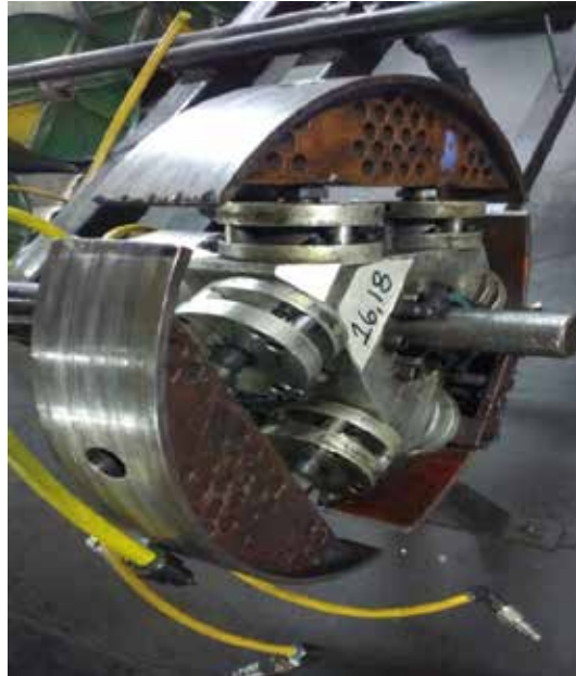
Figura 21: Hormas en estado de corrosión
