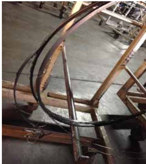
Figura 25: Pestaña simétrica alambre expuesto
