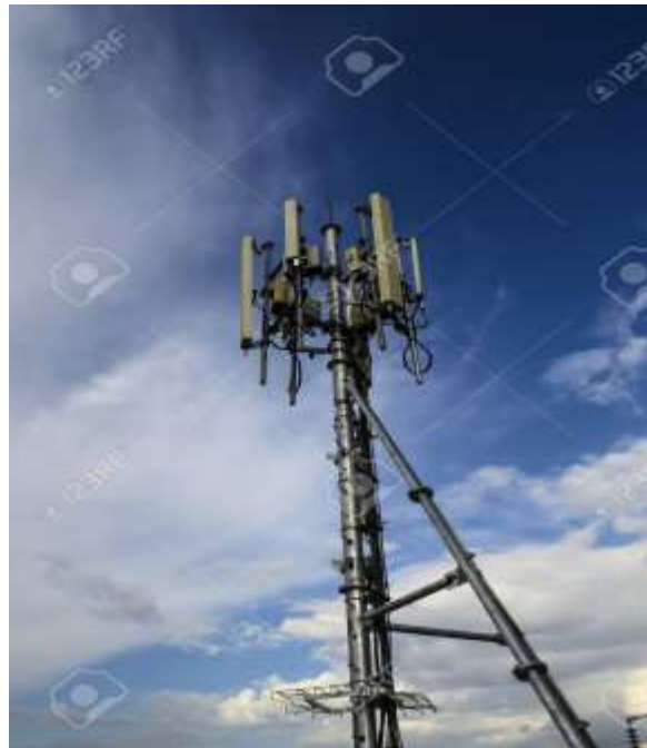
Figura 13. Mástil de telecomunicaciones
