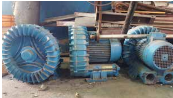
Figura 16: Bombas de vacío de 4 HP del depósito Autor: Romero, J (2020)
