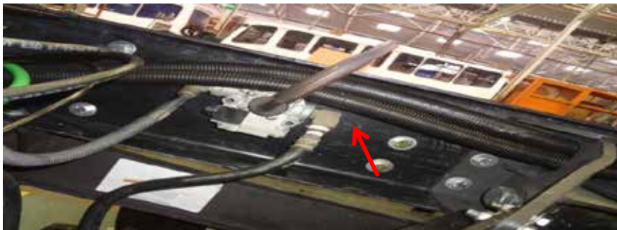
Figura 53. Ejemplo del ruteo de los arneses de cableado a través del conjunto del chasis, protegiéndose de las altas temperaturas del sistema de postratamiento.
