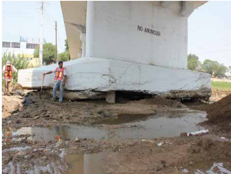
Figura 15 Socavación en Pilas.
