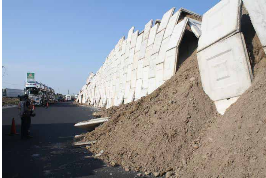
Figura 16 Colapso muro de contención. Fuente: e-veracruz.com
