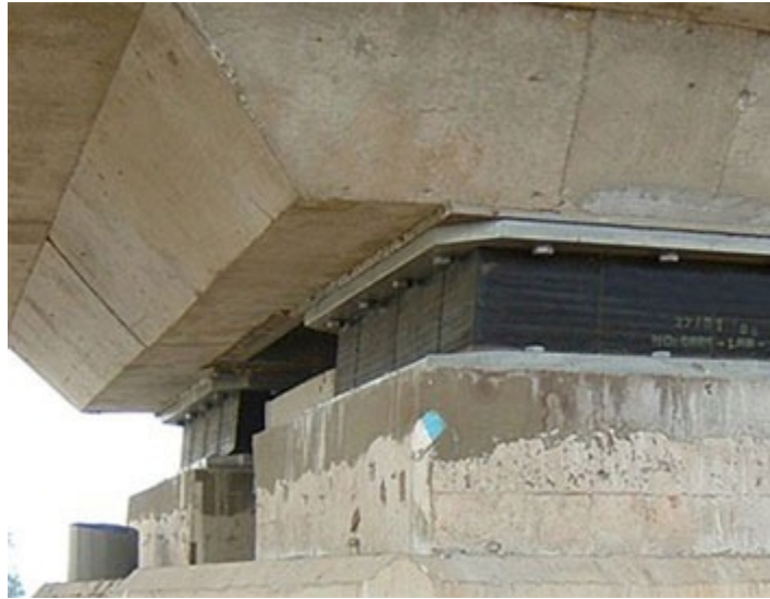
Figura 18 Deterioro en apoyos
