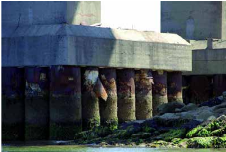
Figura 17 Deterioro en pilas
