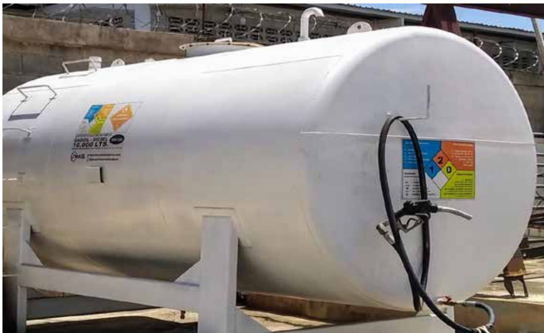
Figura 28: Tanque de combustible Fuente: Empresa Proyectos Metalúrgicos C.A
