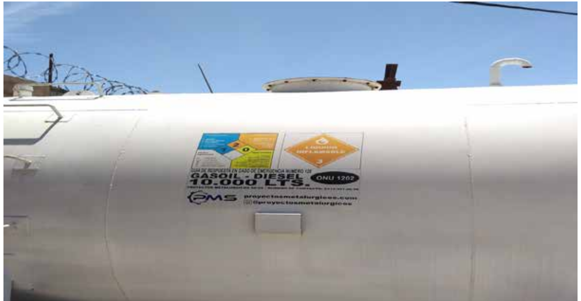
Figura 27: Tanque de combustible Fuente: Empresa Proyectos Metalúrgicos C.A
