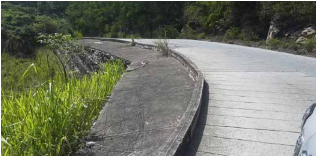
Figura 37 Déficit de señalización
