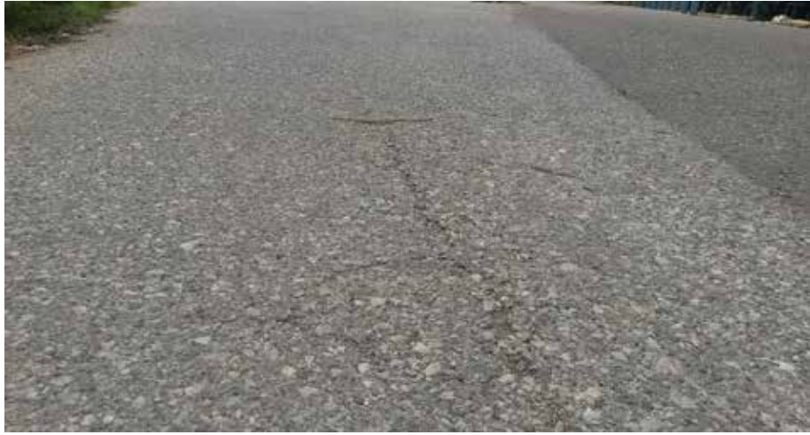
FIGURA 35 Falla longitudinal de pavimento flexible
