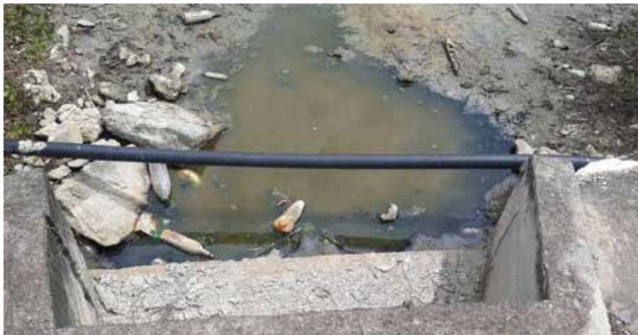
Figura 28 Degradación en los materiales por salitre
