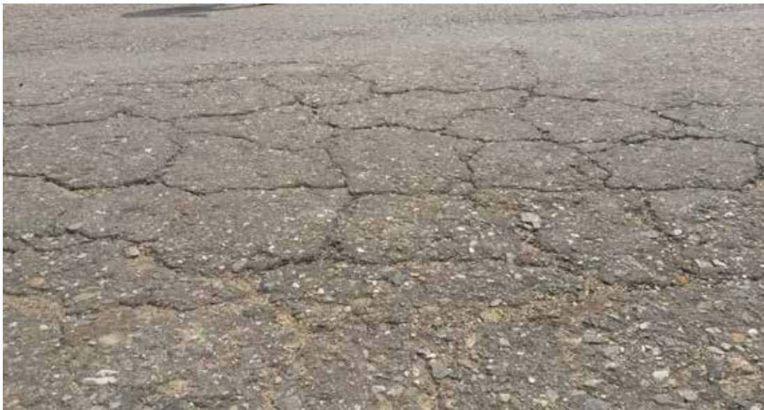
Figura 34 Falla de pavimento flexible de tipo piel de cocodrilo
