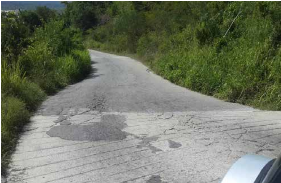
Figura 36 Falla de pavimento rígido por asentamiento y sobrecarga
