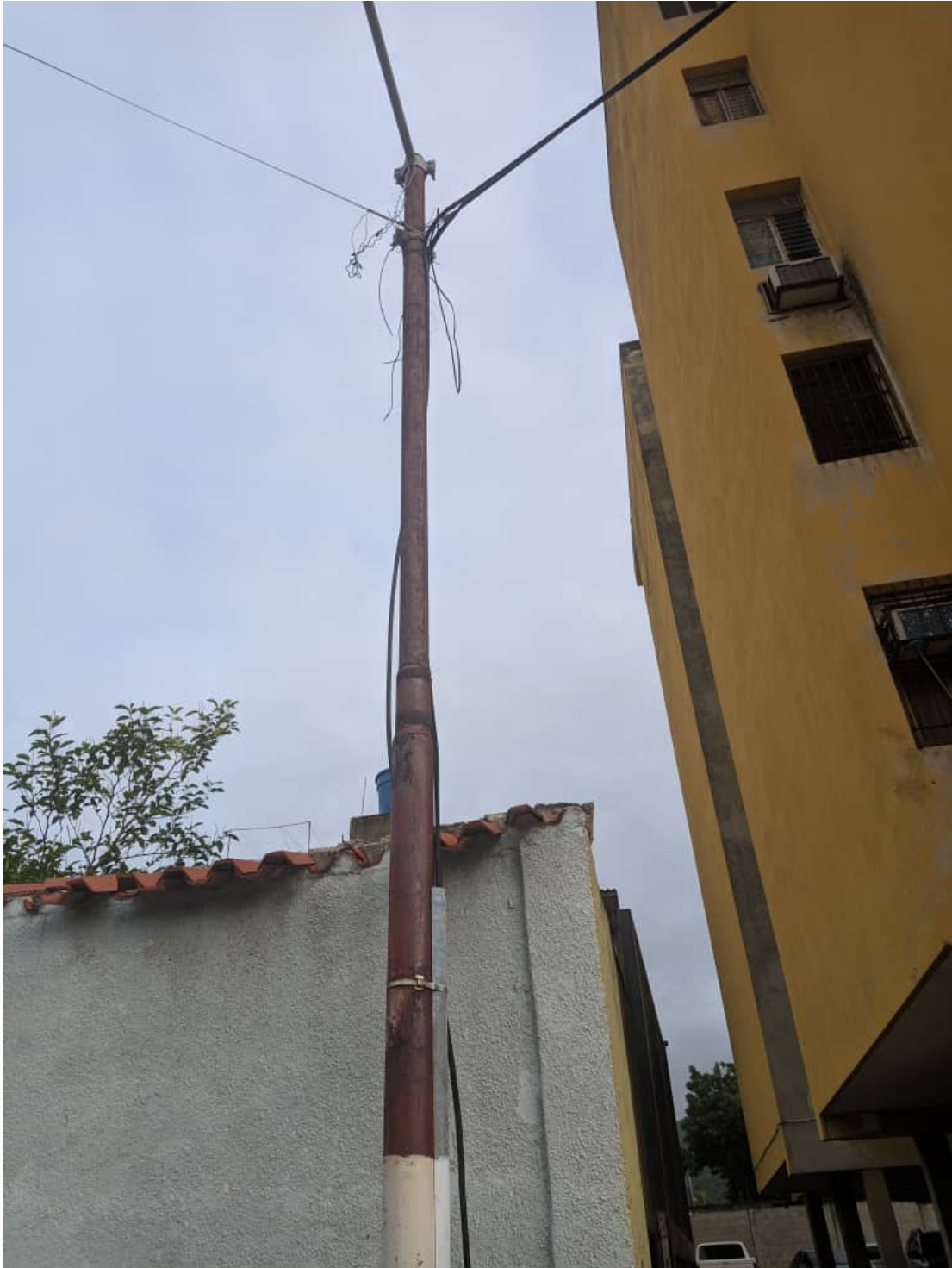
Figura 32: Poste donde llega la línea de cobre de CANTV
