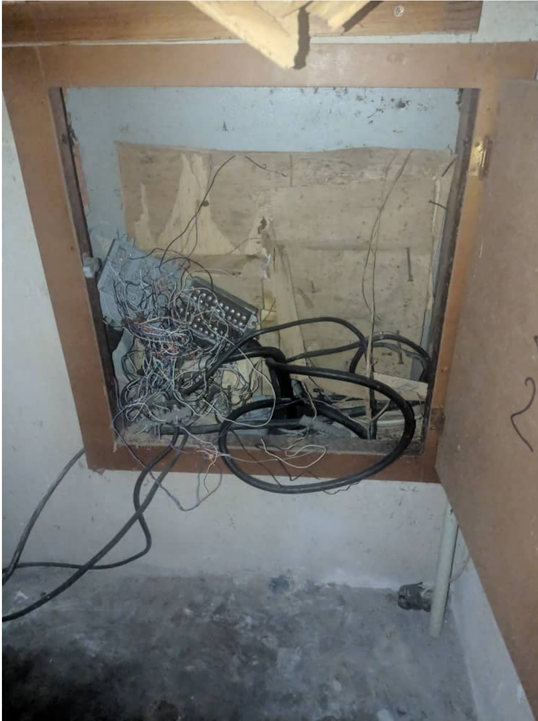
Figura 35: Armario de distribución CANTV en edf. El Remanso
