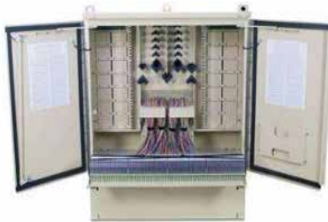
Figura 25: Armario de GPON (FDH)
