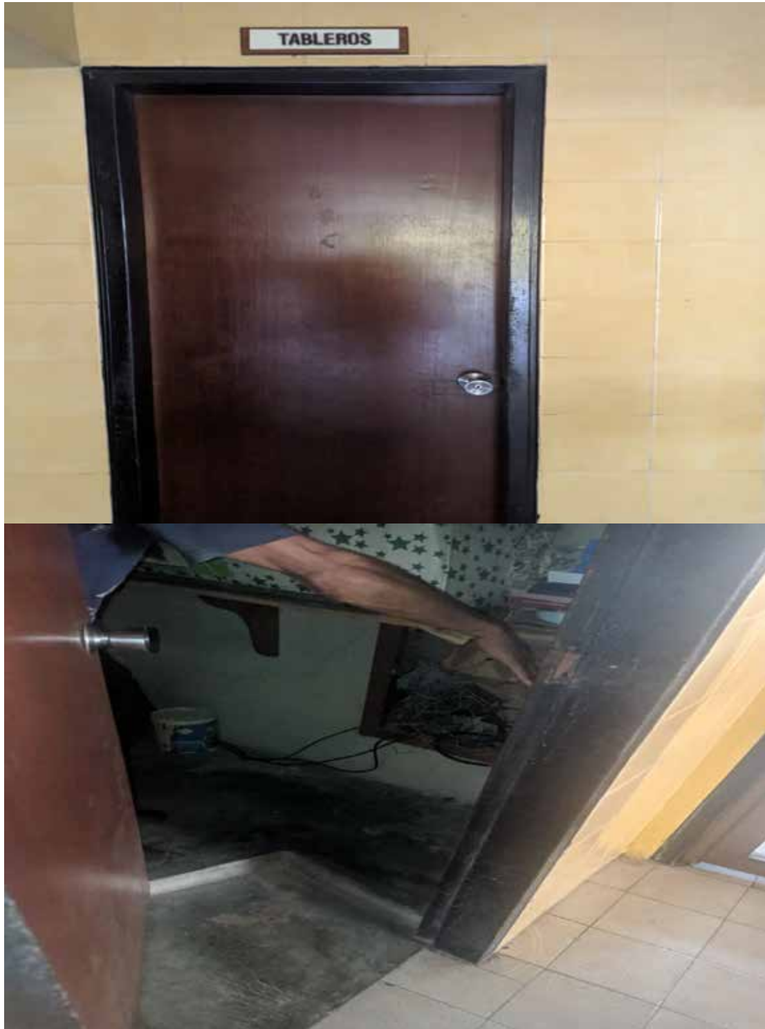
Figura 34: Cuarto de Tableros del edf. El Remanso
