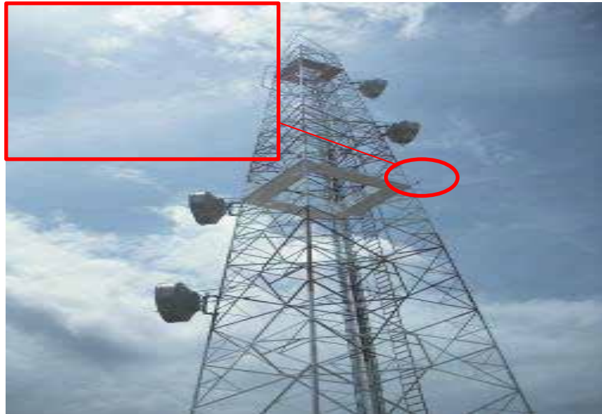
Figura 50. Ubicación de la antena en la torre autoportada de Chorore con vista El Chivo
