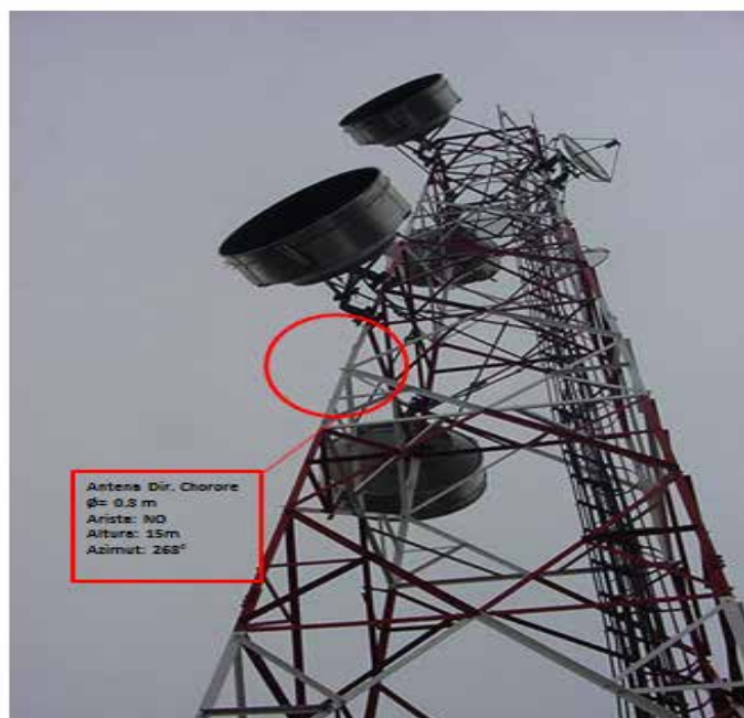
Figura 51. Ubicación de la antena en la torre autoportada de El Chivo con vista Chorore
