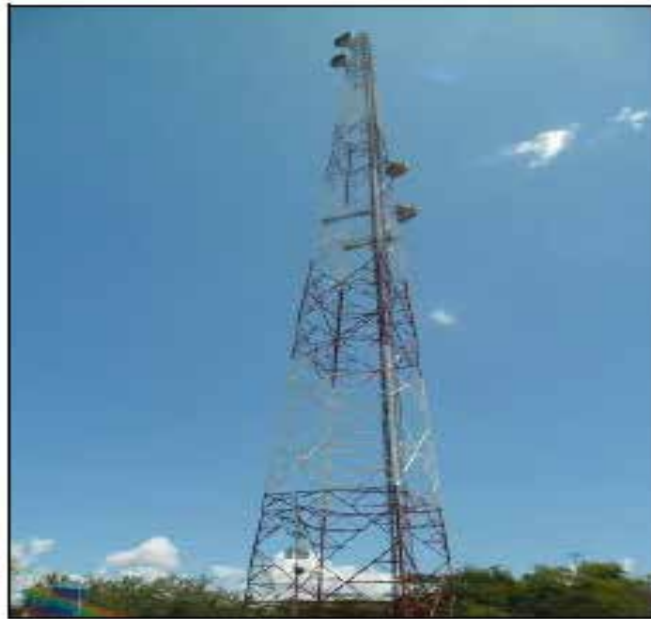
Figura 19. Torre autoportada de la estación N53.
