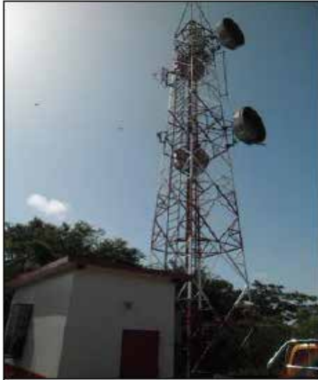
Figura 23. Torre autoportada de la estación El Chivo.
