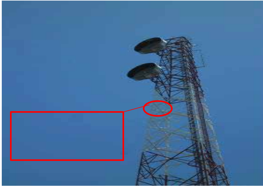
Figura 43. Ubicación de la antena en la torre autosoportada de N53 con vista a Chorore.
