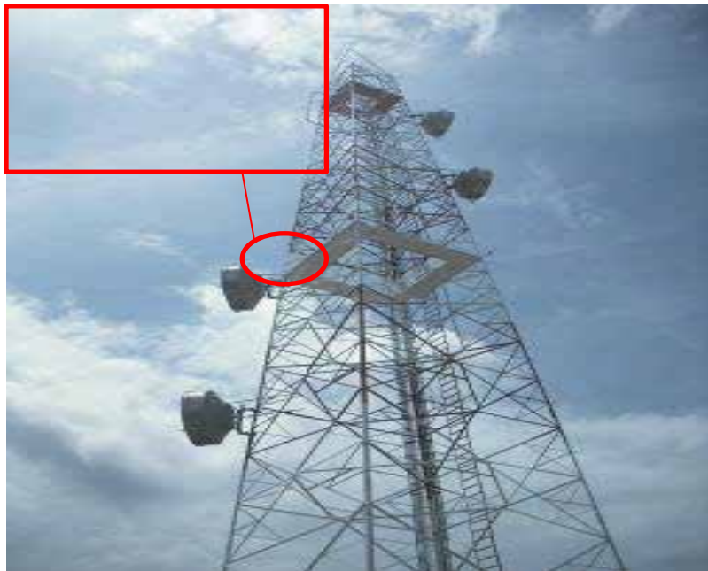
Figura 44. Ubicación de la antena en la torre autosoportada de Chorore con vista N53
