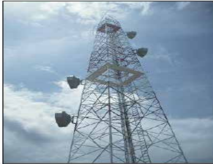
Figura 21. Torre autoportada de la estación Chorore
