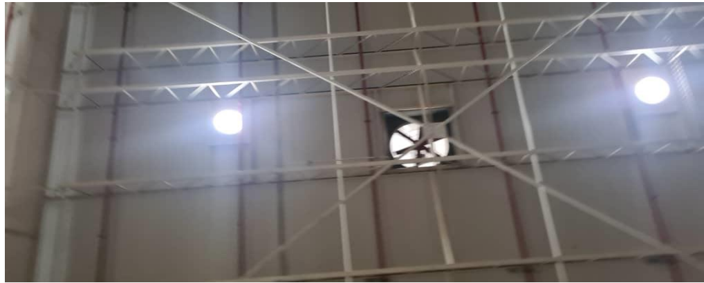
Figura 17: Tragaluz y extractor de aire Autor: Devia y Fung año 2023
