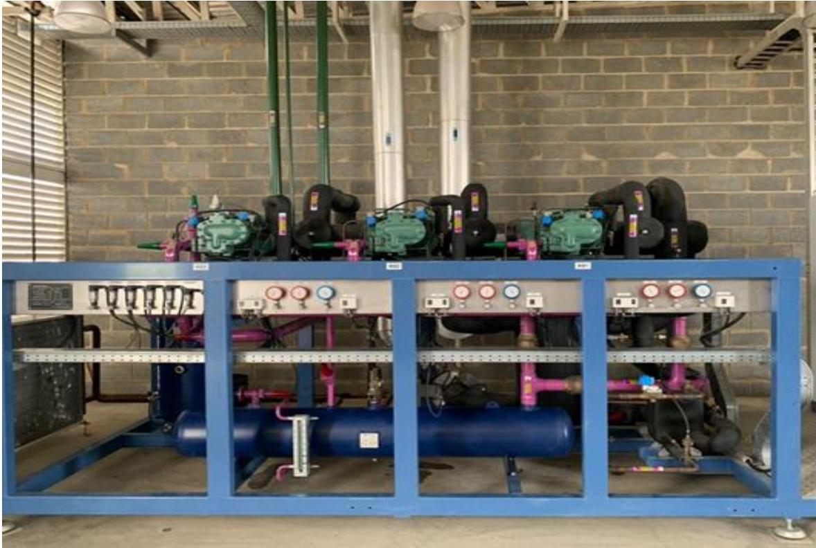
Figura 11: Sistema de rack de compresores
