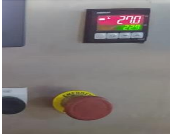
Figura 27. Controlador Omron para el control de temperatura.
