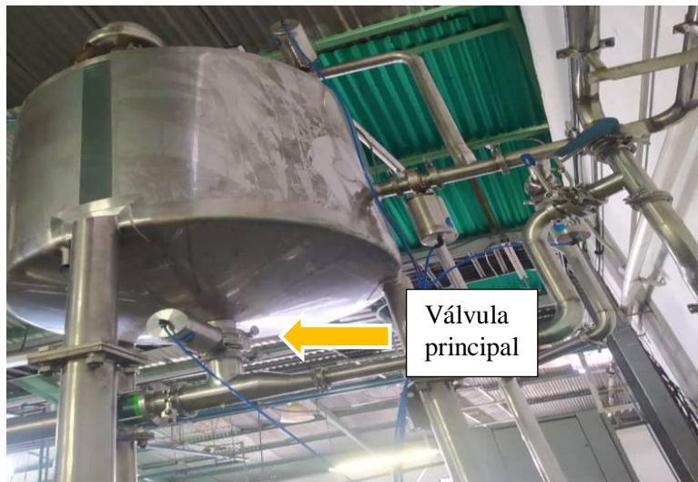
Figura 21. Válvula de drenaje del jarabe para la máquina llenadora.
