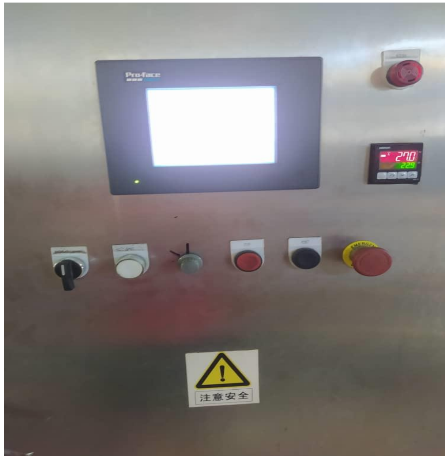
Puerta de tablero con HMI, controlador de temperatura y botones.
