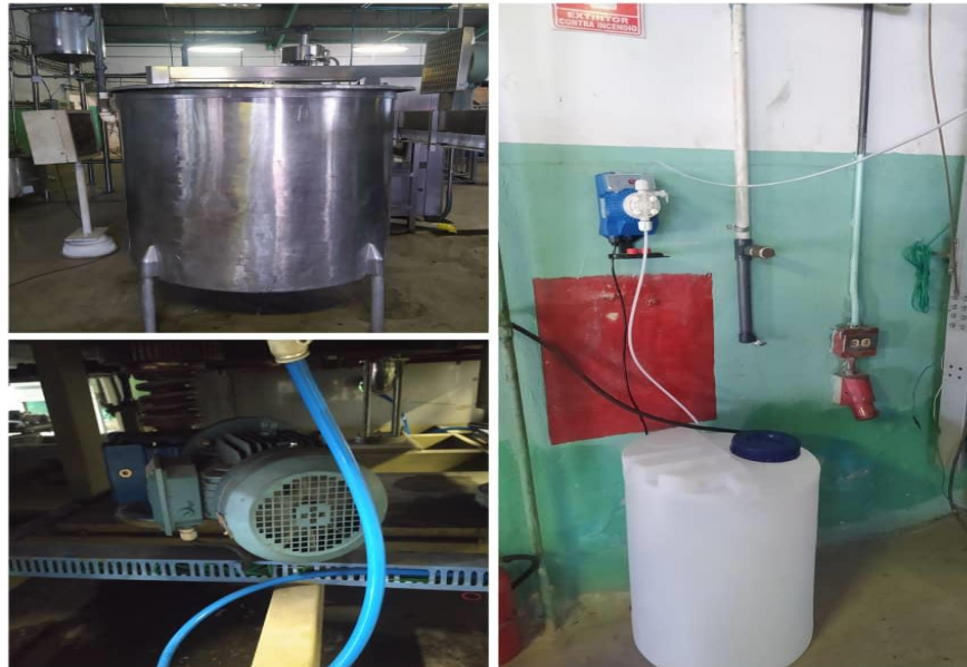
Figura 48. Tanque principal de agua y tanque de cloro para la dosificación de lavado de las botellas.
