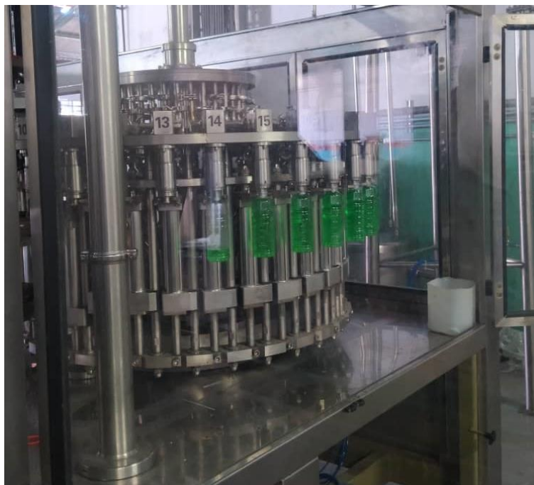
Figura 51. Pistones de llenado y cubierta de campana.
