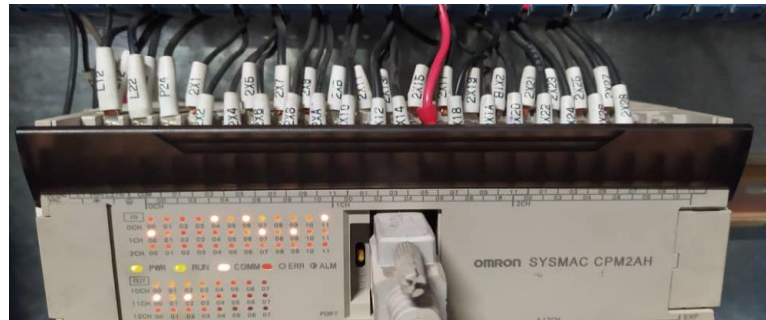
Figura 15. Conexiones a entrada del PLC.
