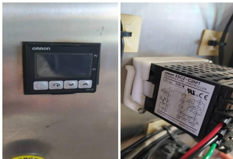
Figura 26. Controlador Omron para la temperatura.
