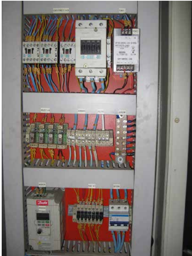
Figura 23. Tablero de control. Sección de protecciones Fuente. Muñoz (2017)
