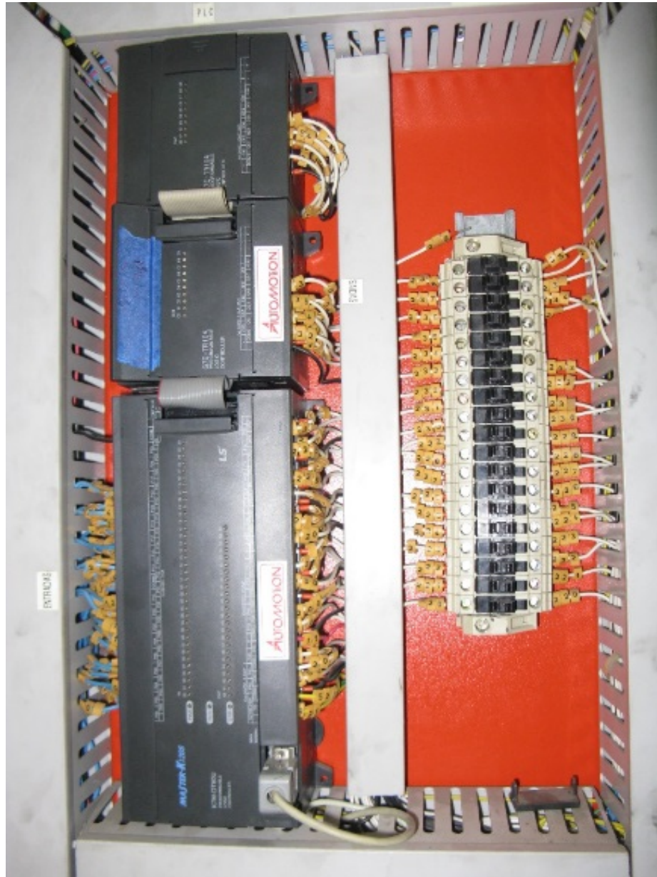
Figura 22. Tablero de control. Sección del PLC Fuente. Muñoz (2017)
