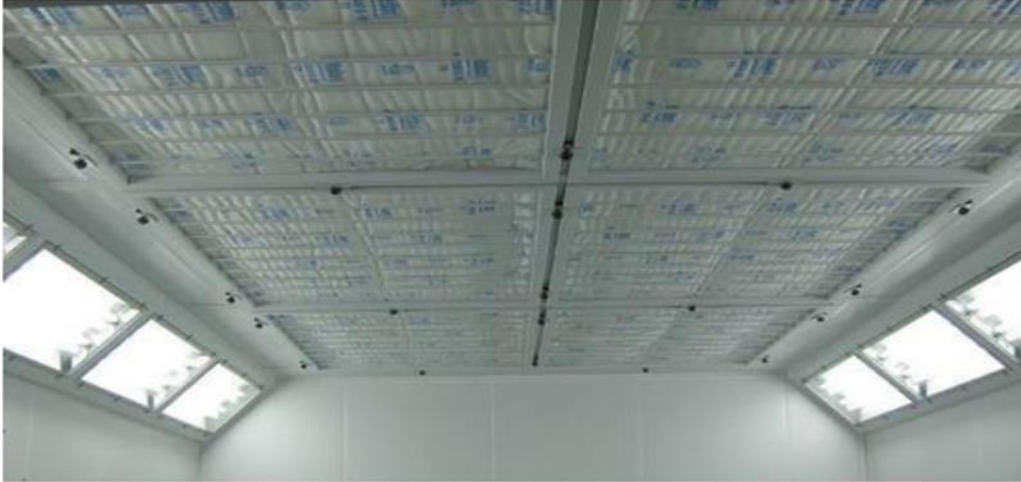
Figura 19. Filtro plénum Fuente: (Sisvent, 2014)
