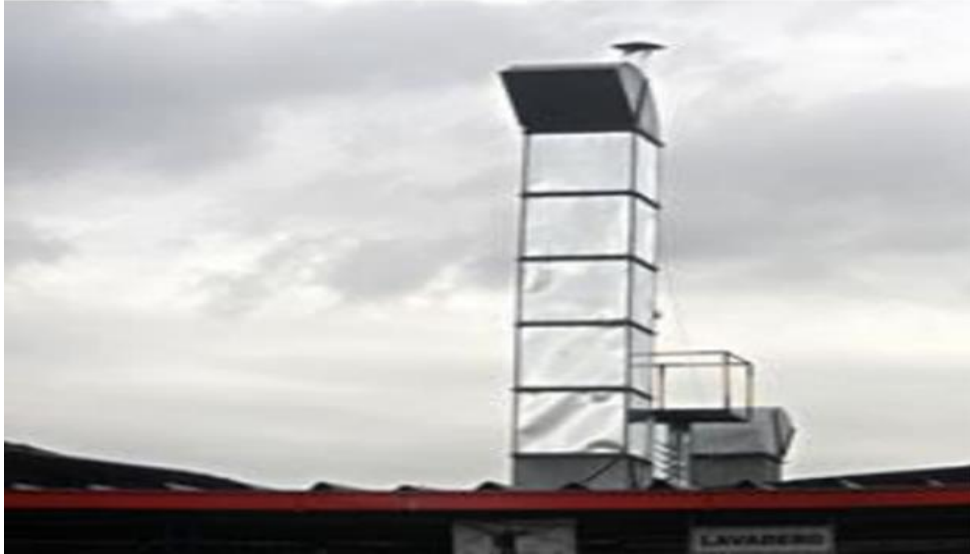
Figura 17. Ductos Fuente: (PracoDidacol, 2013)
