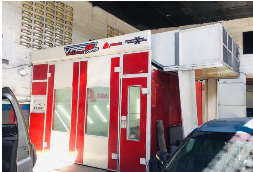
Figura 13. Cabina-Horno de pintura Fuente: Camacho-Parra (2022)
