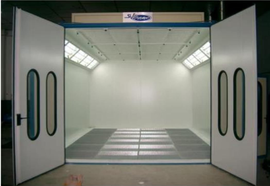
Figura 22. Iluminación de cabina de pintura
