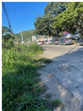
Figura 22: Pavimento deteriorada por la falta de elementos de drenaje
